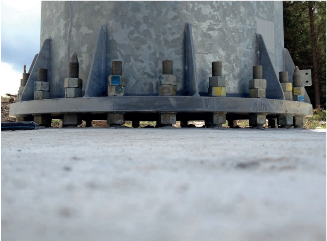
Fotot visar botten på en kompaktstolpe. Grundskruvarna runt om är 28 till antalet, 39 millimeter grova och 2 meter långa. De är gjutna in i fundamentet och håller stolpen på plats.
