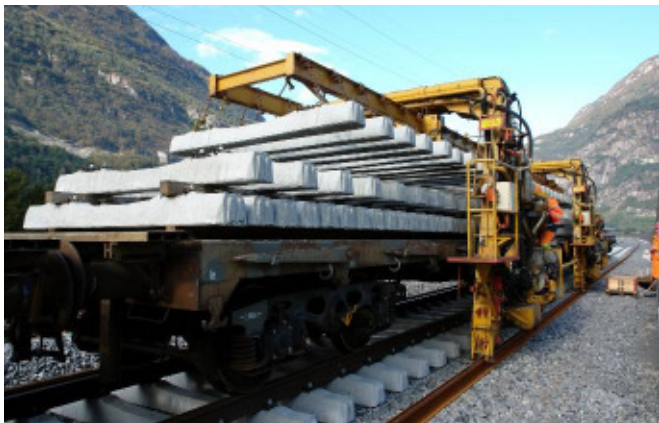
Der Bau des Gotthard-Basis-Tunnels schreitet voran. Hier, bei Biasca, werden bereits die Gleise verlegt. Foto: © AlpTransit Gotthard AG.
