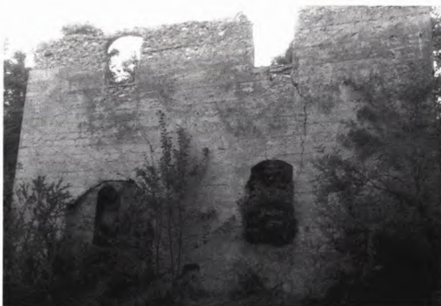
7 ALLMENDINGEN, Ruine der Zementmühle.
