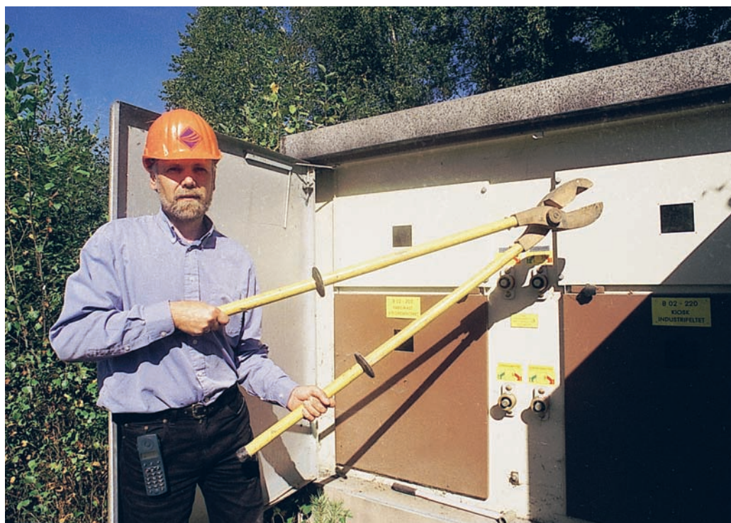
Drifts- og plansjef Birger Slupstad viser hvordan man ved hjelp av isolert tang byttet høyspentsikringer i transformatorer i gamle dager. (Foto: Per Erik Nilssen)
