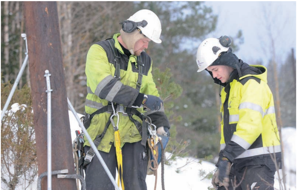
Jan Egil Viken instruerer lærling Fredrik Bangshaug hvor viktig det er at sikkerhetsreglene følges nøye. Foto: Bjørn Ivar Bergerud.
