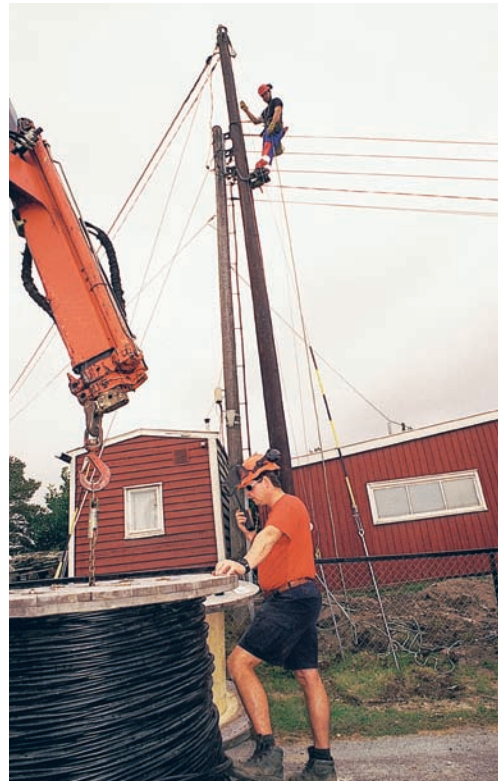
Montørformann Bjørn Ingar Sønsthagen ved trommelen og montør Bjarte Vinterli Hoel i masta skifter kabel på Bjørnelangen. (Foto: Per Erik Nilssen)
