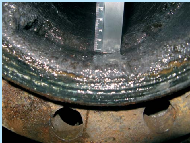
4. Замер линейкой величины отложений (12 мм) на внутренней стенке трубопровода на контрольном участке по состоянию на 24 января 2008 г.
