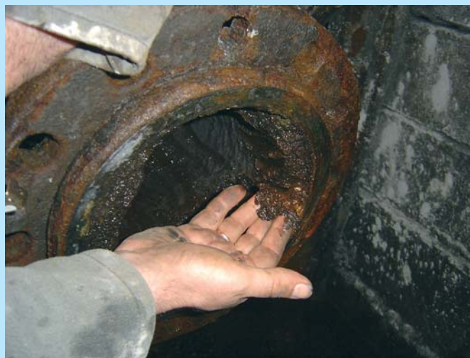
2. Состояние минеральных отложений в трубопроводе, очищаемом аппаратом «Илиос» по состоянию на 22 мая 2007 г. (верхний слой легко снимается рукой)
