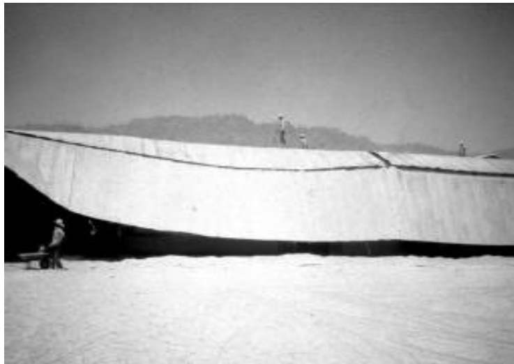
Fig. 26. El peso de la ceniza puede producir el colapso de instalaciones inadecuadamente diseñadas. La foto muestra el techo caído de la terminal camionera de Pichualco, a unos 20 km del volcán El Chichón, que cayó por efecto de una acumulación relativamente pequeña de ceniza.
