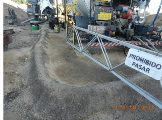
Ilustración 3: Diques de contención de derrames alrededor de depósitos de combustible en planta de mezcla asfáltica
