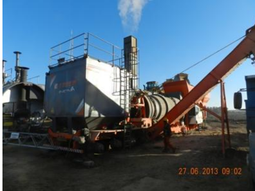
Ilustración 2: Planta de mezcla asfáltica en operación
