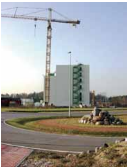
Das Biomassekraftwerk geht im Dezember 2006 in Probebetrieb Fotos: Hafen Eberswalde
