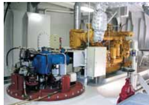
Die Verhaar Bugstrahlruderanlage mit 530 PS Caterpillar Motor Bild: Veldhuijzen
