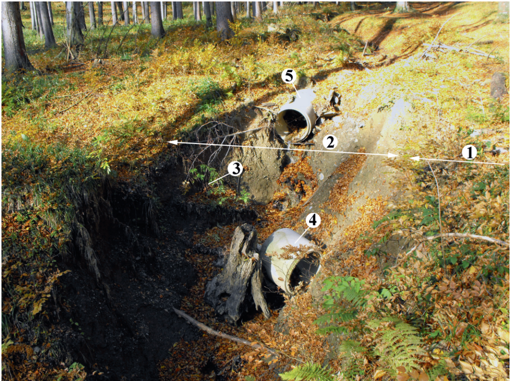
12. ábra. Az I. jel szelvényhelyénél a Bozsoki-völgy medre (felvétel ideje: 2010.10.30.) Jelmagyarázat: 1. Bozsoki-völgy talpa, 2. a meder, 3. mederoldal leomlott része 4. kimozdult betongy r , 5. a híd helyben maradt betongy r je
