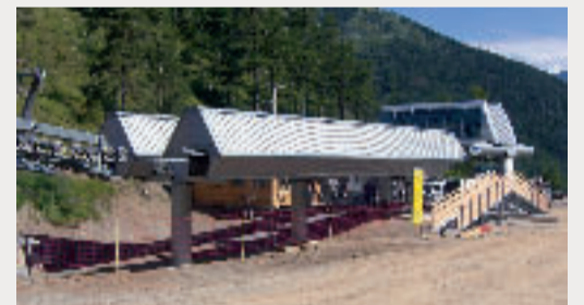
▲ BEREITS SEIT DEM SOMMER IST DIE KUPPELBARE 4ER-SESSELBAHN DES TYPUS ALPHA IN LA COLMIANE IN DER NÄHE VON NIZZA ZUR GROSSEN FREUDE DER FAHRGÄSTE IN BETRIEB. EIN BEISPIEL FÜR EINE ABSOLUT ERFOLGREICHE VERLEGUNG UND WIEDERVERWENDUNG EINER ANLAGE ZWISCHEN ZWEI BENACHBARTEN SKIGEBIETEN
