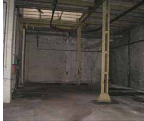
De locatie van de vroegere 'timmerfabriek'. Deze ruimte is ontstaan na het verwijderen van een deel van de oorspronkelijke muur. De uit twee U-profielen samengestelde kolom zat in deze muur weggewerkt.
