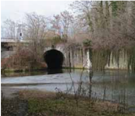
De laatste en als enige overgebleven overwelfde tunnel over de Zuid-Willemsvaart, waarna de tunnel in een rechte lijn in noordwestelijke richting doorstroomt.
