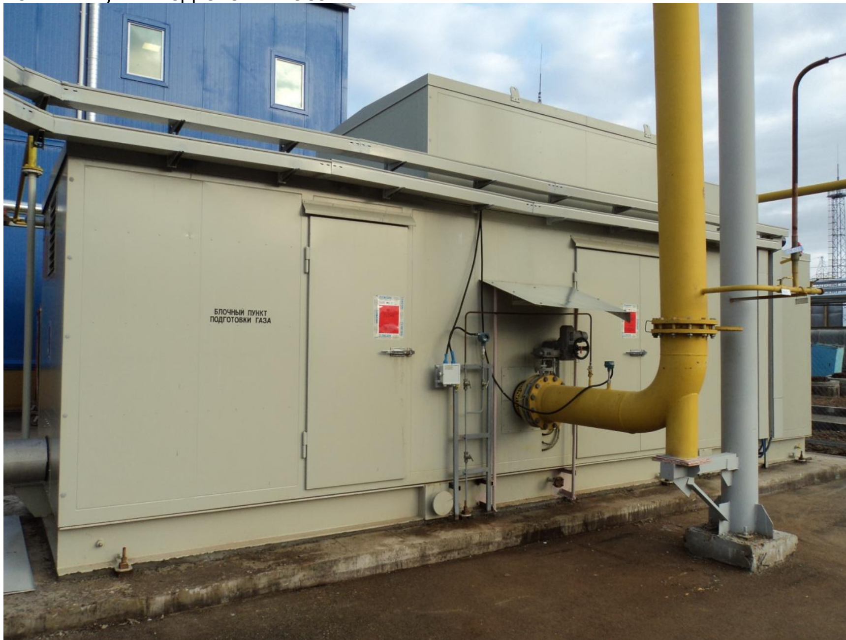
Блочный пункт подготовки газа
