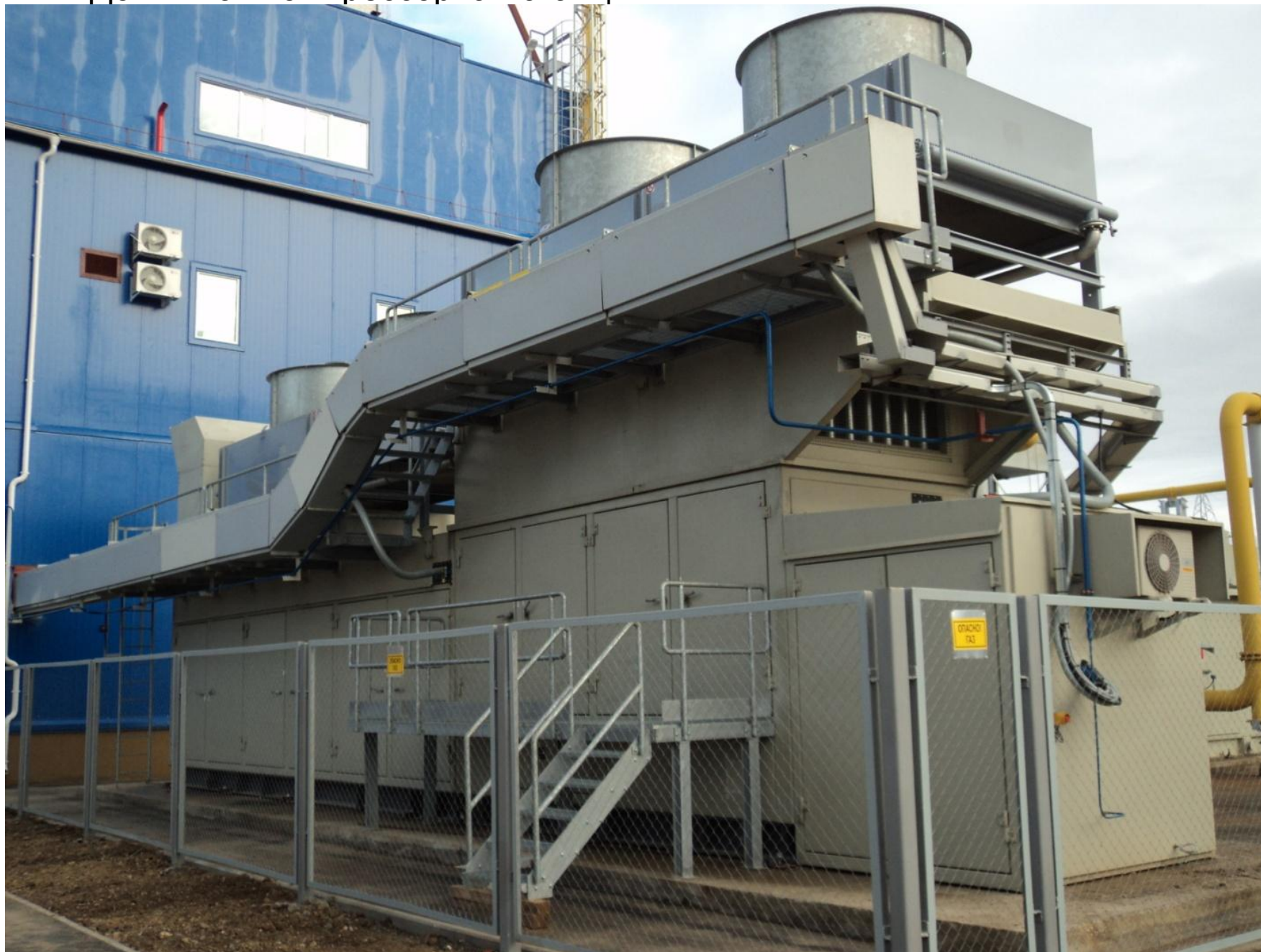
Дожимная компрессорная станция
