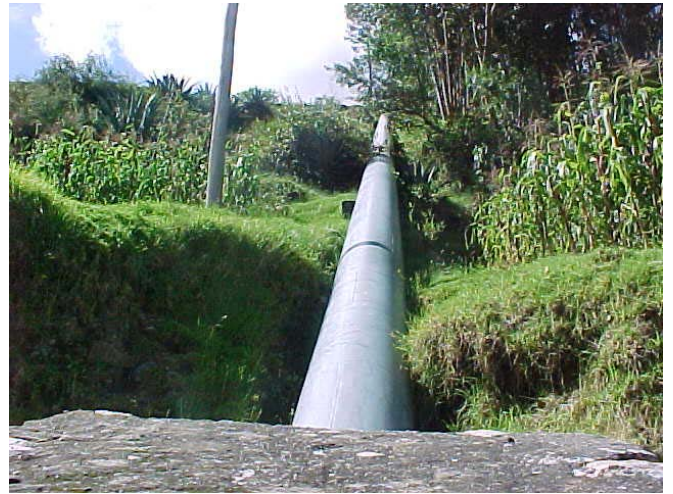
Tubería de presión
