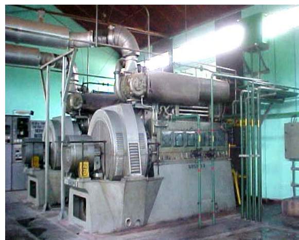
Sala de control y grupos
