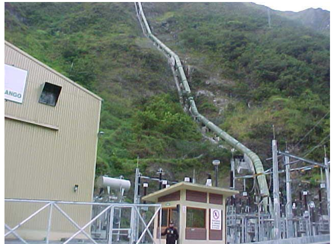
Patio de llaves y tubería de presión
