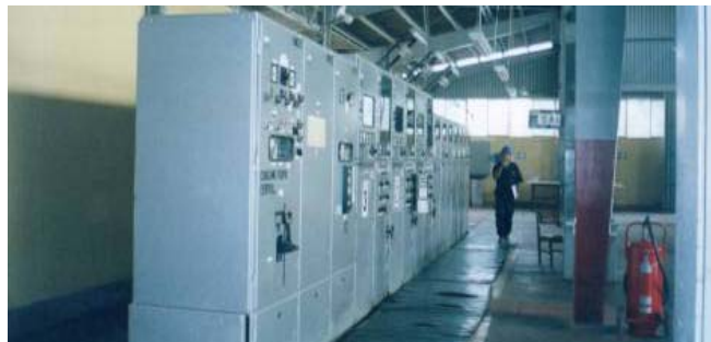
Sala de máquinas - tableros de control
