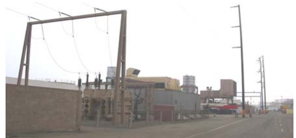
Turbina a vapor y transformadores
