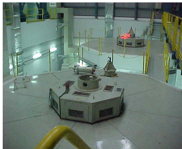
Casa de máquinas - generadores
