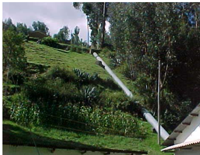
Tubería de presión
