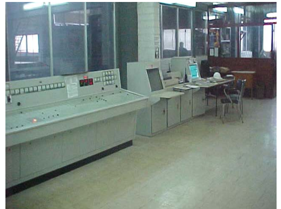
Sala de control
