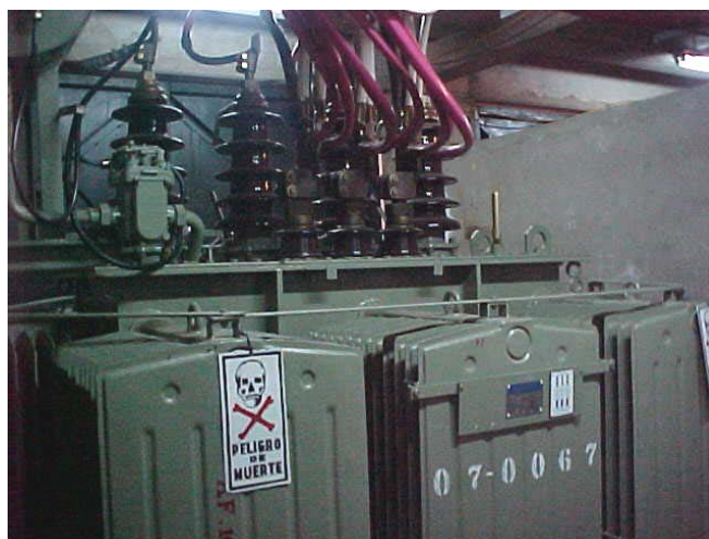
Transformador de potencia
