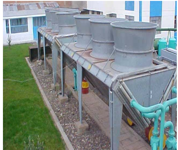
Torres de enfriamiento
