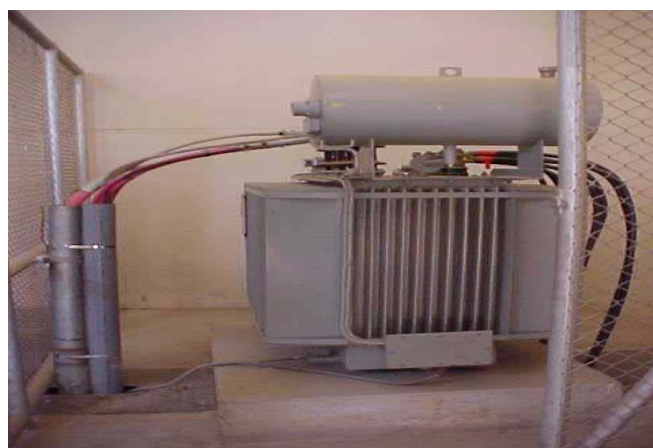
Transformador de potencia
