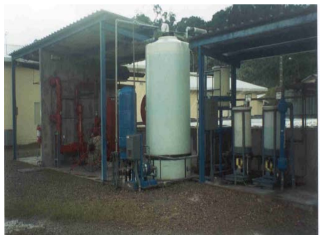
Sistema de agua contra incendio
