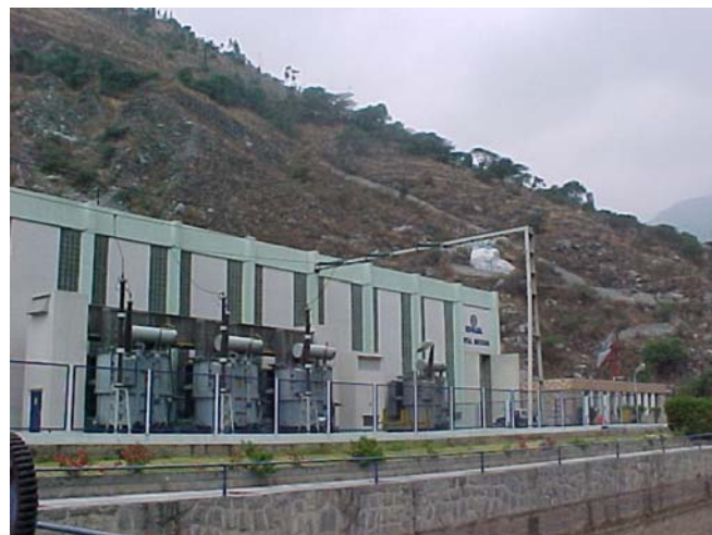
Casa de máquinas - transformadores
