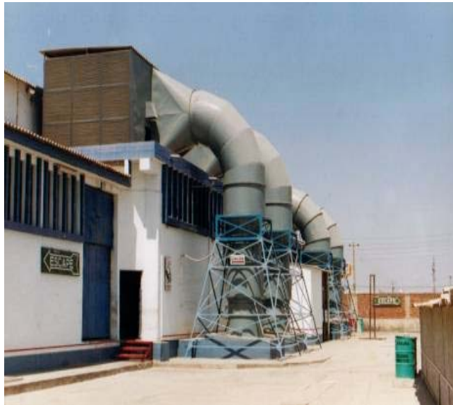
Ventilación forzada para grupos diesel
