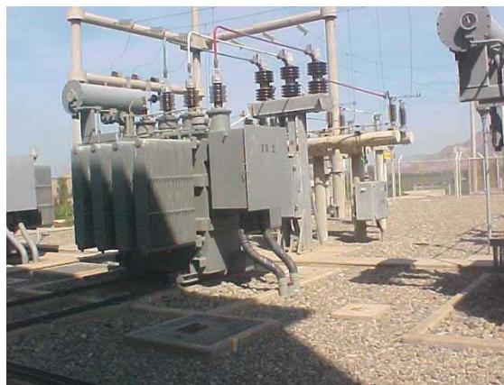
Transformador de potencia
