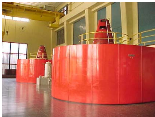
Sala de máquinas -generadores
