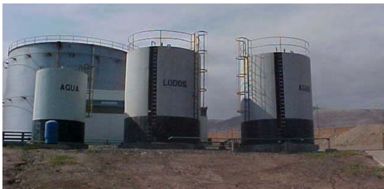
Tanques almacenamiento de combustible
