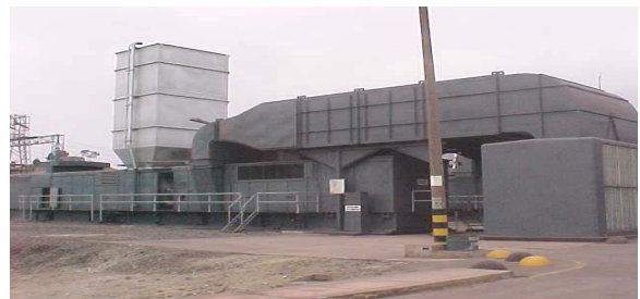
Turbina de gas – TG3
