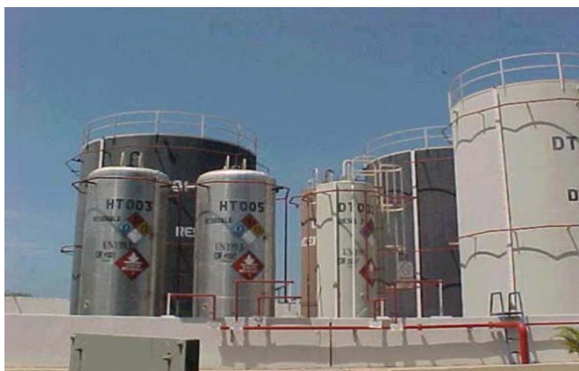
Tanques de combustible
