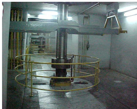
Eje acoplamiento generador - turbina
