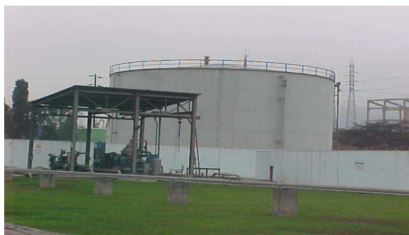
Tanque de combustible
