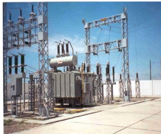
Transformador de potencia
