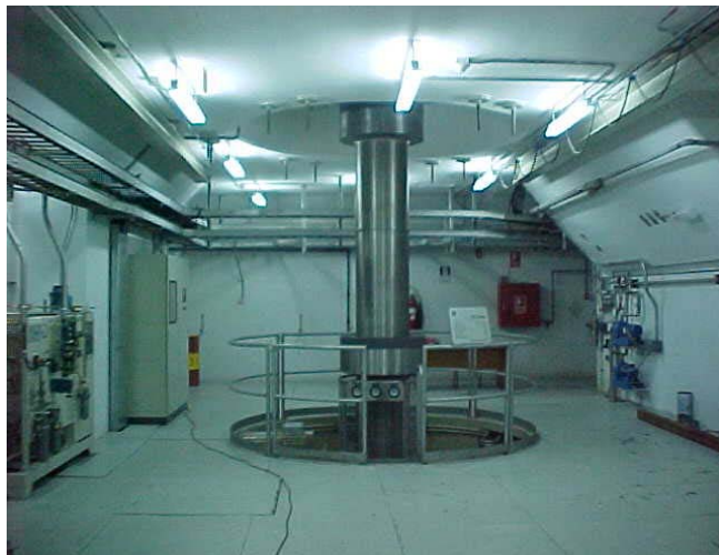
Casa de máquinas – eje de acoplamiento generador -turbina
