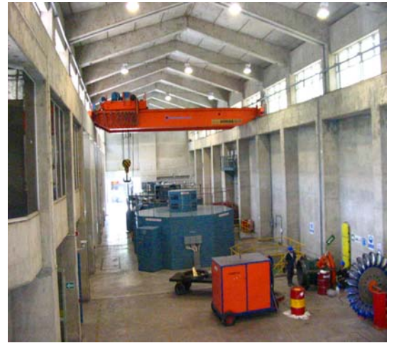
Sala de máquinas
