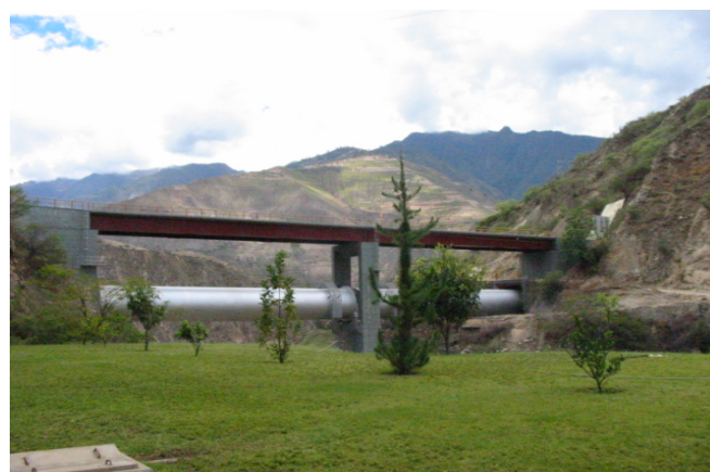
Puente Tubo – Captación del agua turbinada de la C.H. Mantaro
