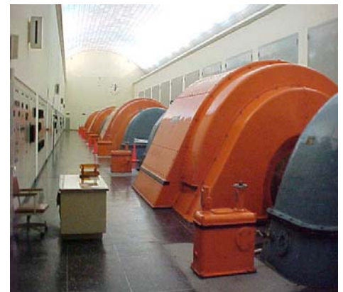
Casa de máquinas – grupos generadores
