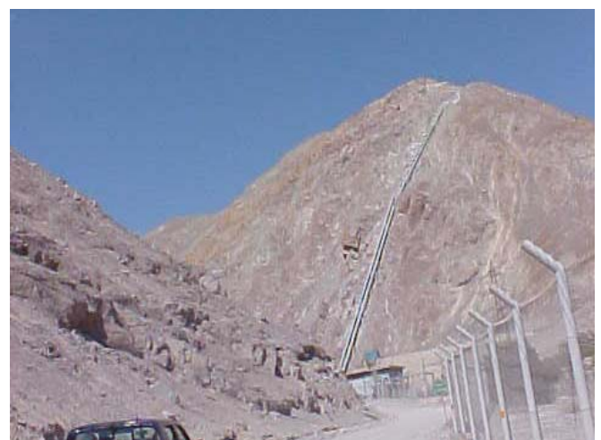
Tubería de presión
