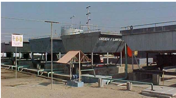
Torres de enfriamiento
