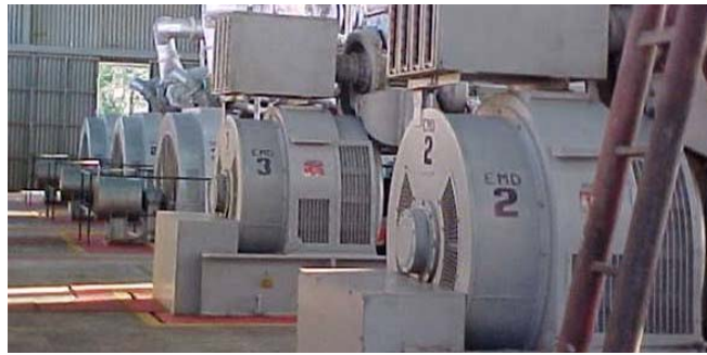
Sala de máquinas - grupos EMD
