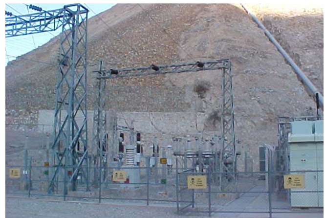
Patio de llaves y tubería de presión
