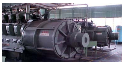
Sala de máquinas - grupos
