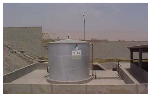
Tanque de combustible
