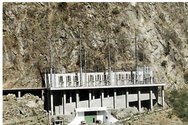
Ingreso a la sala de máquinas y patio de llaves en la parte superior
