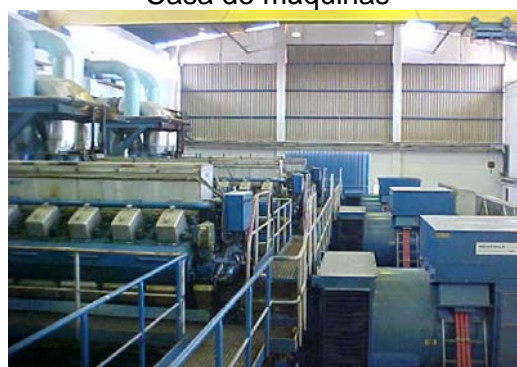
Sala de máquinas
