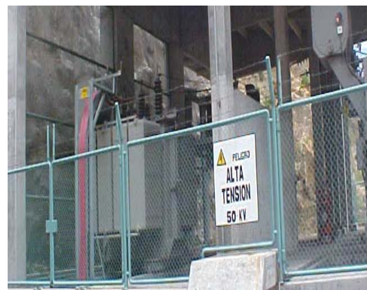
Subestación de la central
