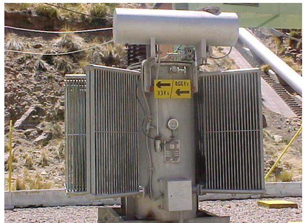
Transformador de potencia
