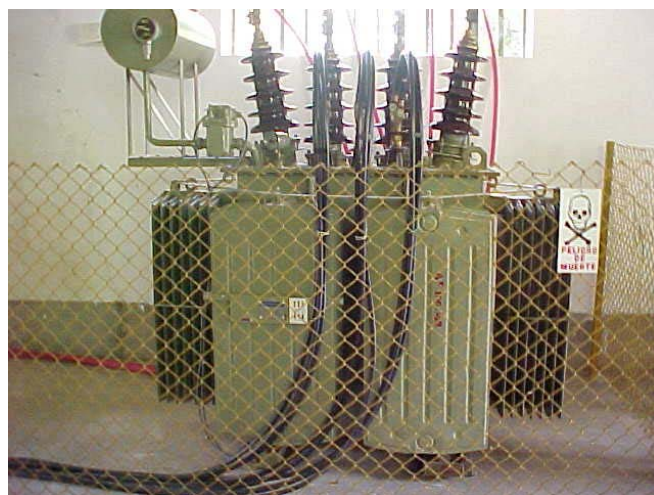
Transformador de Potencia
