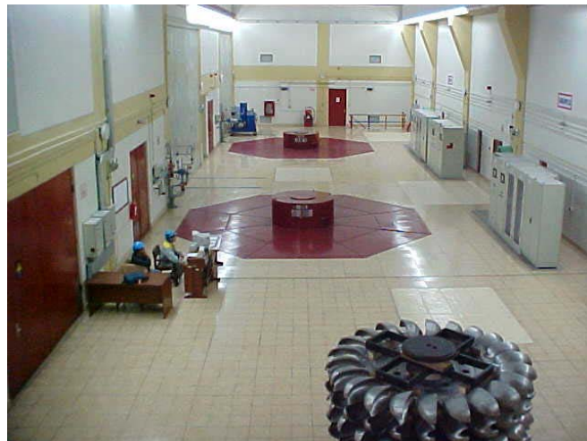
Sala de máquinas
