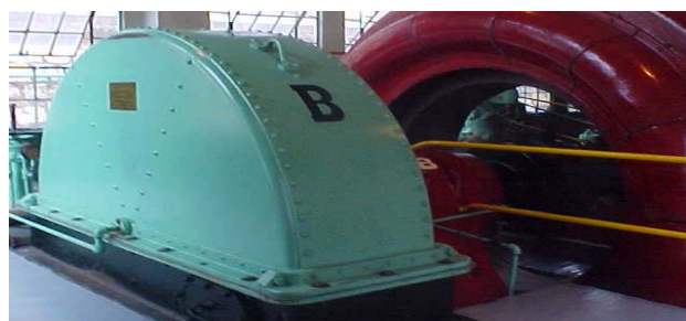
Generador y turbina
