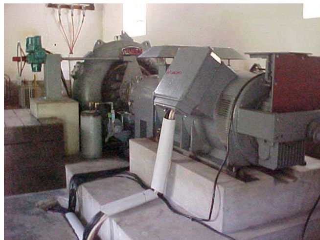
Sala de máquinas
