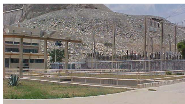
Patio de llaves y casa de máquinas
