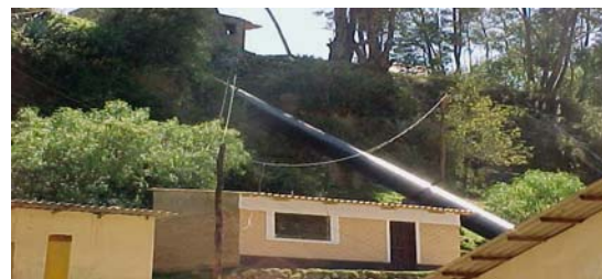
Tubería de presión
