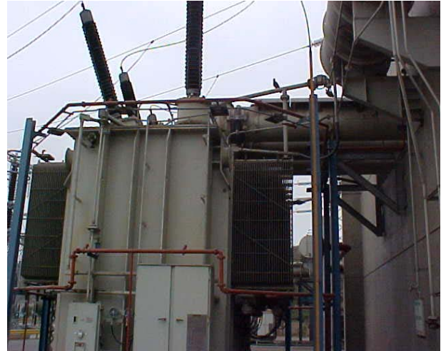
Transformador de potencia
