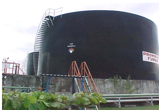
Tanques de combustible
