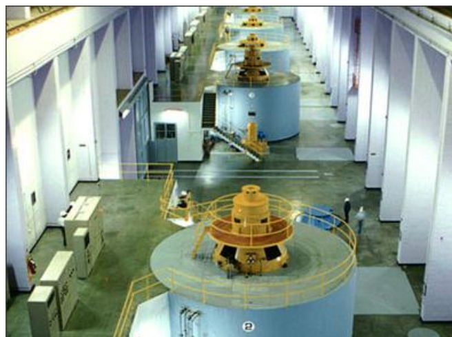
Sala de máquinas
