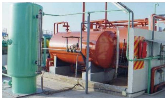
Tanque diario de combustible grupos GMT
