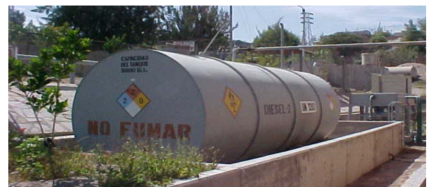
Tanque de almacenamiento
