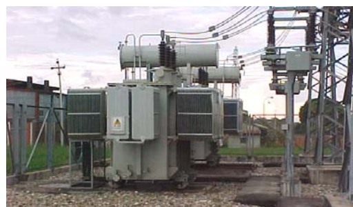
Transformadores de potencia
