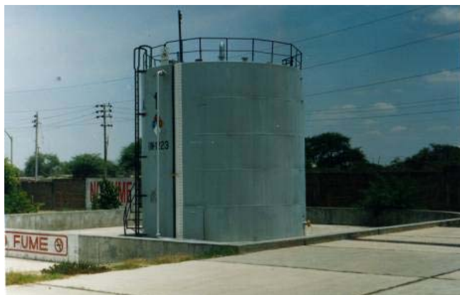
Tanque de combustible
