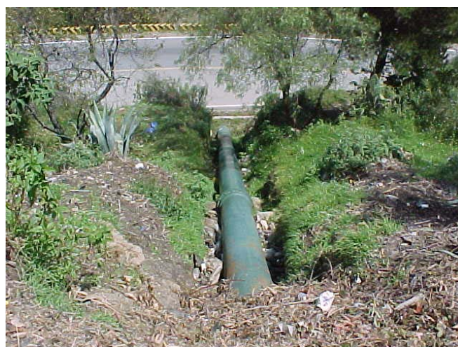
Tubería de presión
