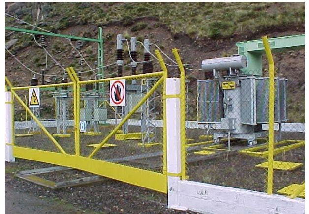
Subestación de la central
