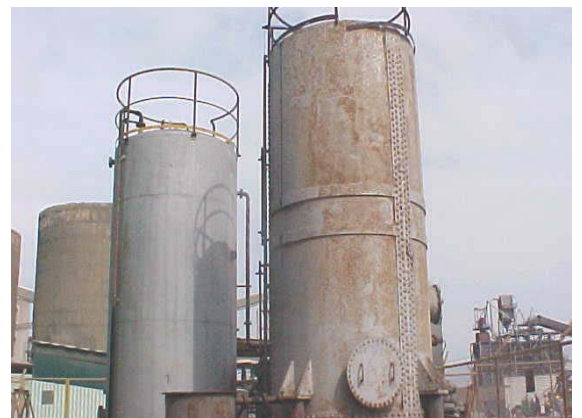
Tanques de combustible
