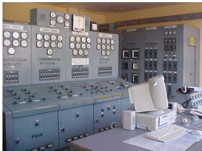
Sala de control - tableros
