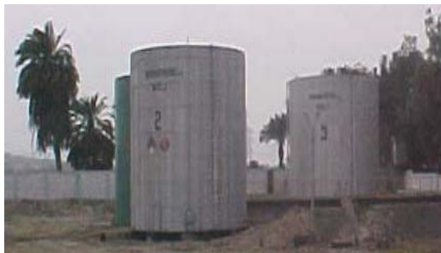
Tanques de almacenamiento de combustible
