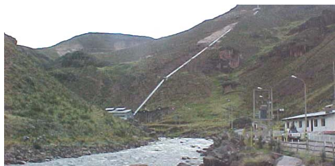
Tubería de presión
