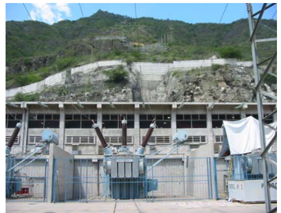
Transformadores de potencia
