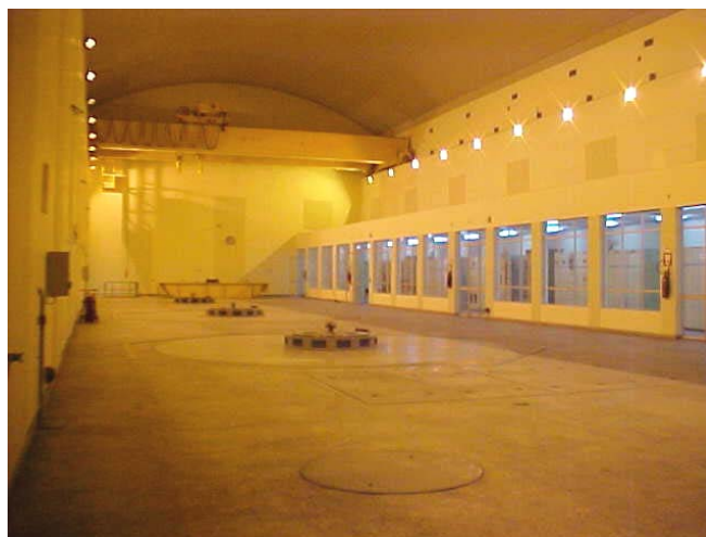
Interior de la casa de máquinas – Grupos de generación
