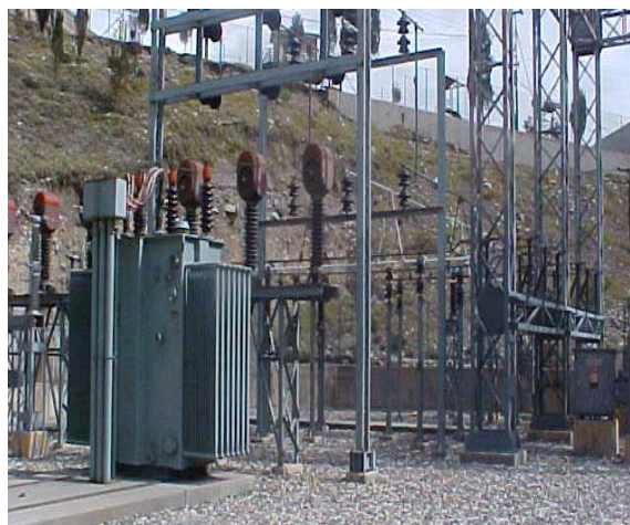
Transformador de potencia
