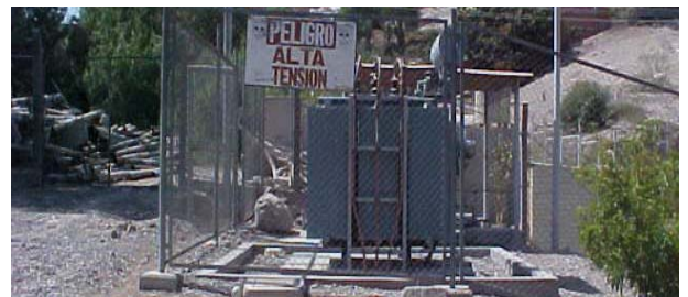
Subestación y transformador
