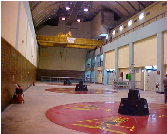
Sala de máquinas
