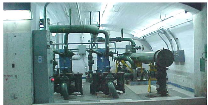
Intercambiadores de calor – sala de máquinas
