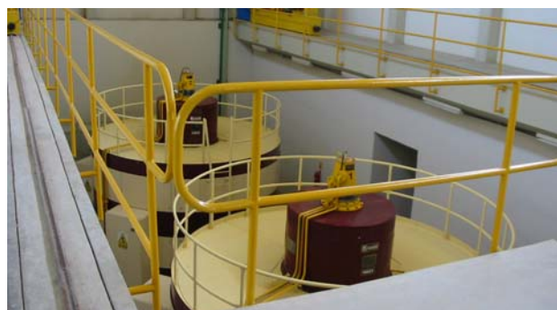
Sala de máquinas
