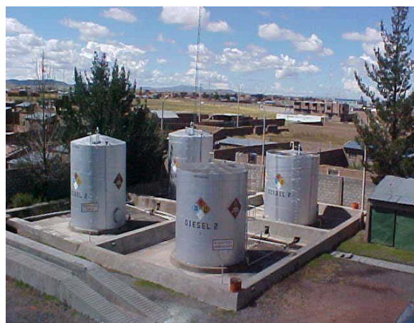
Tanques de combustible
