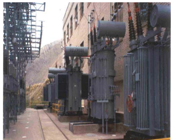
Transformadores de 6.9/50 kV de 17 MVA
