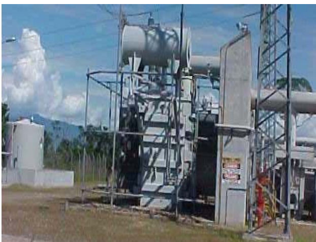
Transformador de potencia
