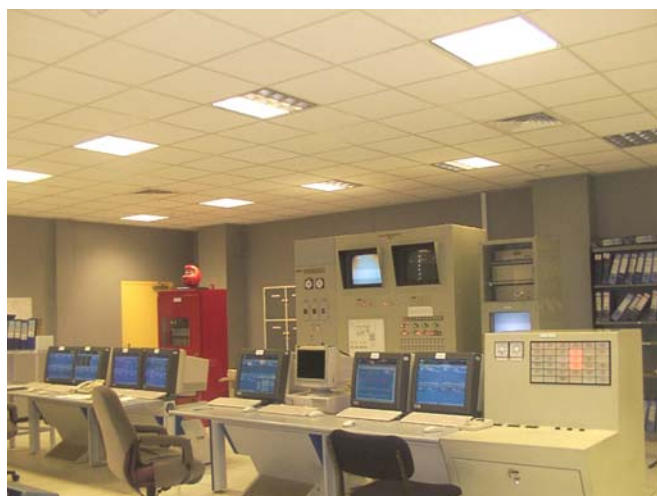
Sala de control
