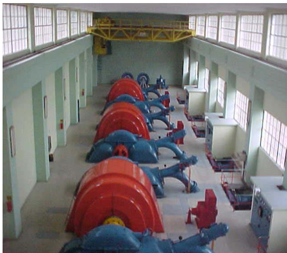
Sala de máquinas
