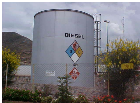
Tanque de combustible D-2
