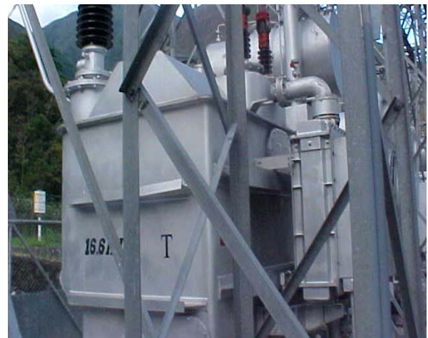
Transformador de potencia Mitsubishi
