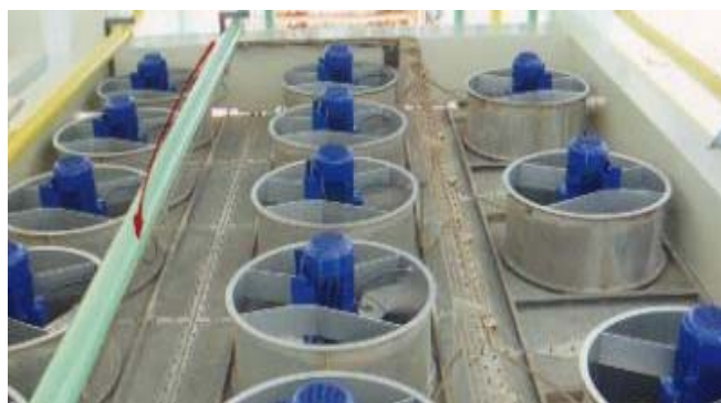
Torres de enfriamiento del sistema de refrigeración
