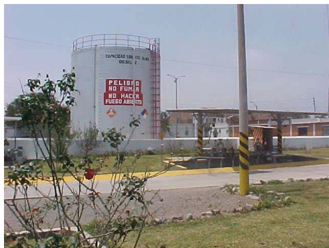
Tanque de almacenamiento de combustible
