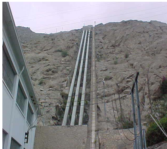
Tuberías de presión
