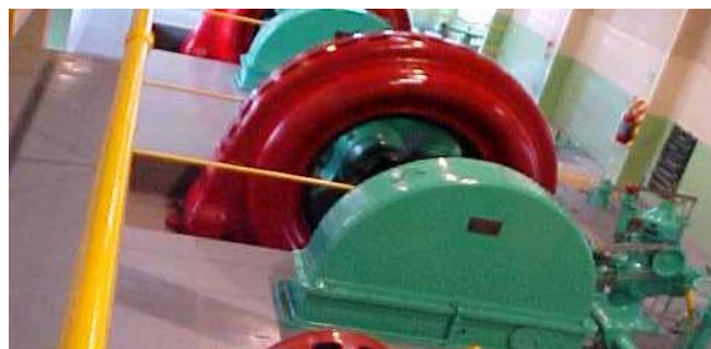
Sala de máquinas
