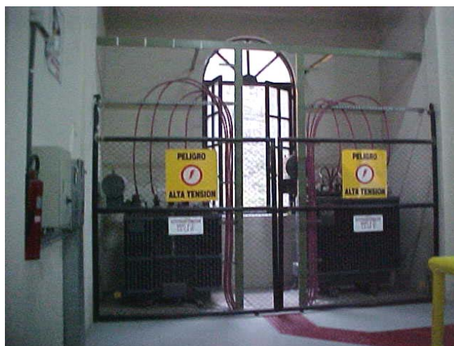
Transformadores de potencia
