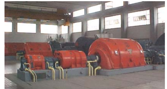
Sala de maquinas grupos BBC
