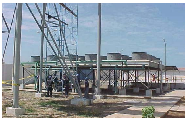
Torres de refrigeración
