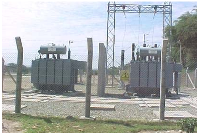
Patio de transformadores
