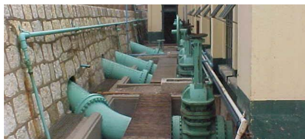
Válvulas de compuerta de ingreso a turbina
