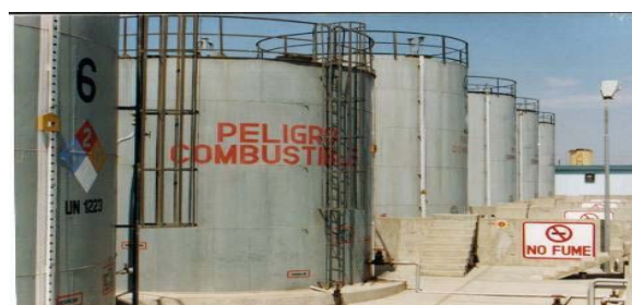
Tanques de combustible
