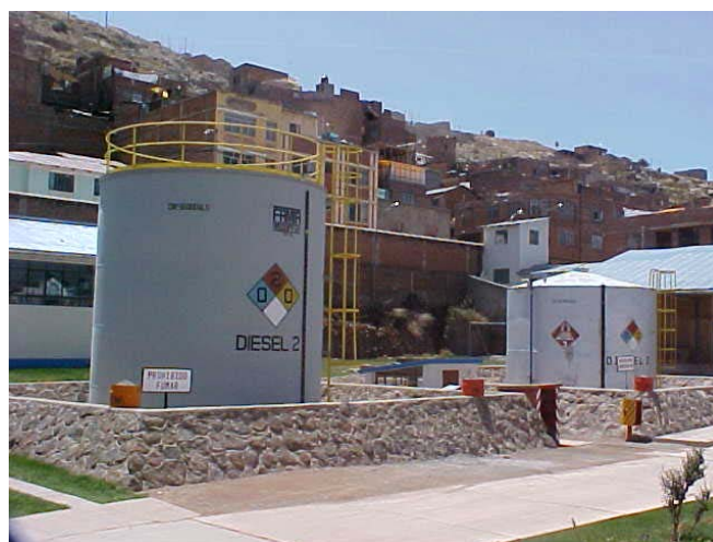
Tanques de combustible
