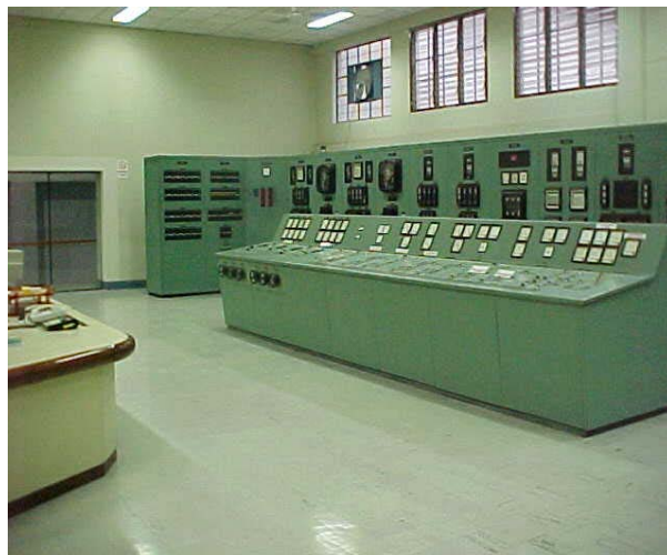
Centro de control
