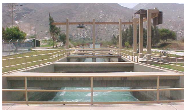
Sistema de compuertas
