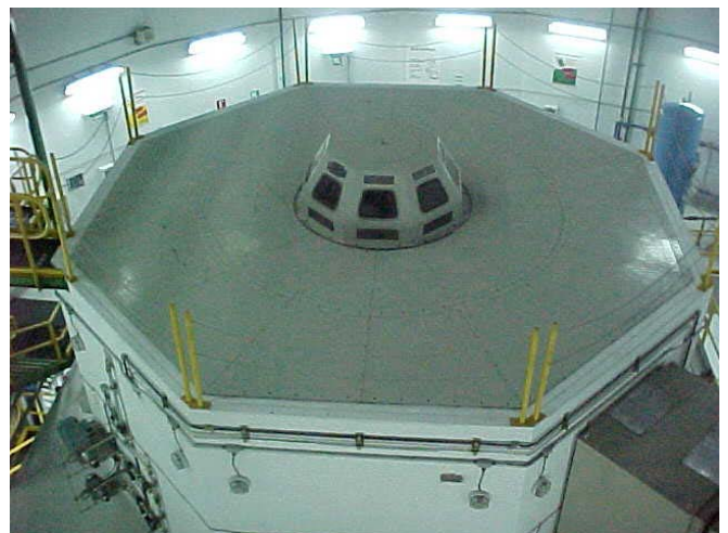
Casa de maquinas - generador
