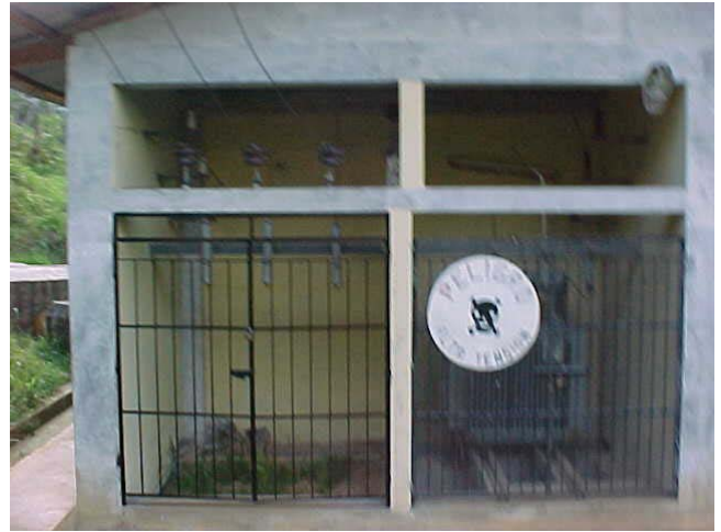
Transformador de potencia
