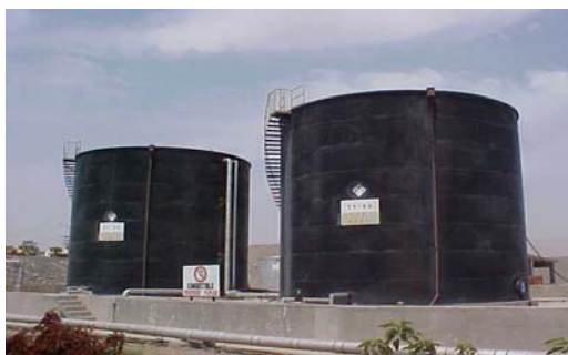
Tanques de almacenamiento
