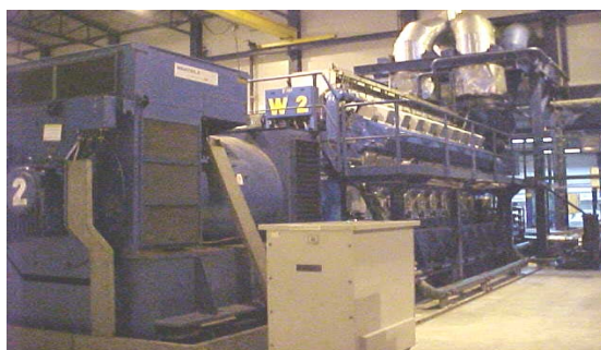
Sala de máquinas - grupo Wartsila
