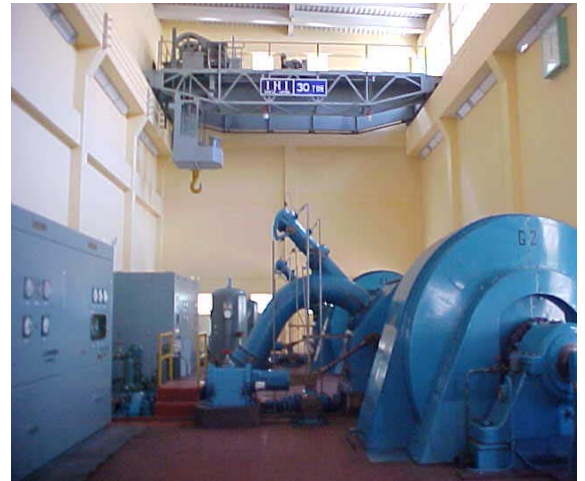
Sala de máquinas - grupos
