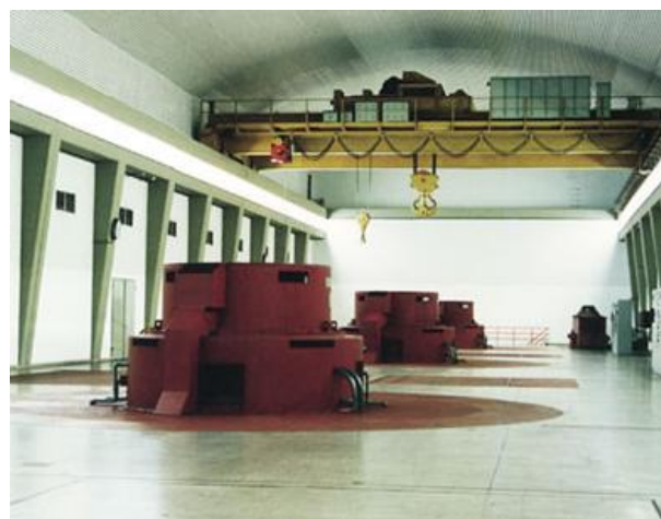
Sala de máquinas
