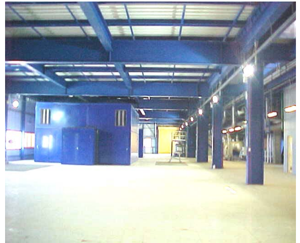
Sala de máquinas
