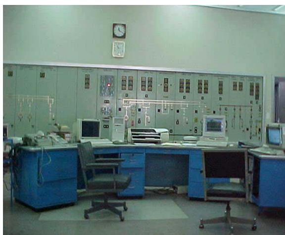
Sala de control
