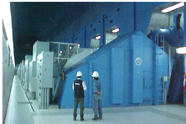
Sala de máquinas - Tableros y grupos
