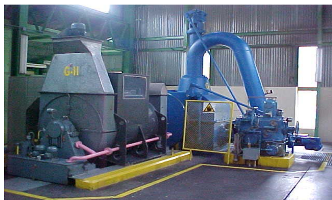
Interior de casa de máquinas
