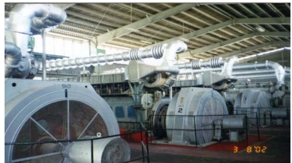
Sala de máquinas
