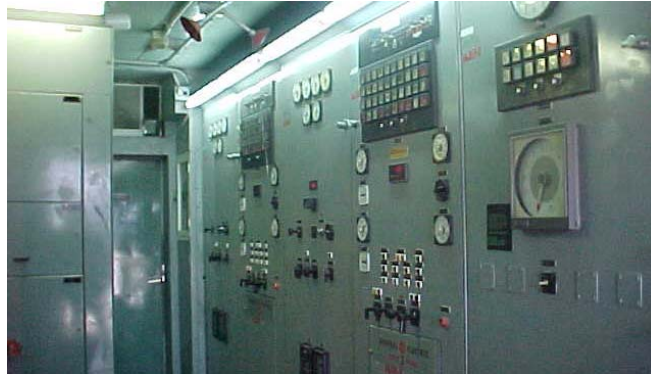
Sala de control – tableros
