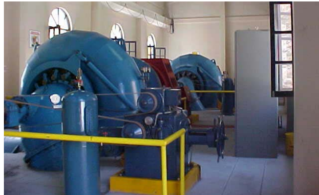
Sala de máquinas - grupos Francis
