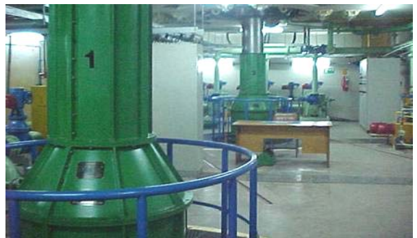
Eje acoplamiento generador - turbina
