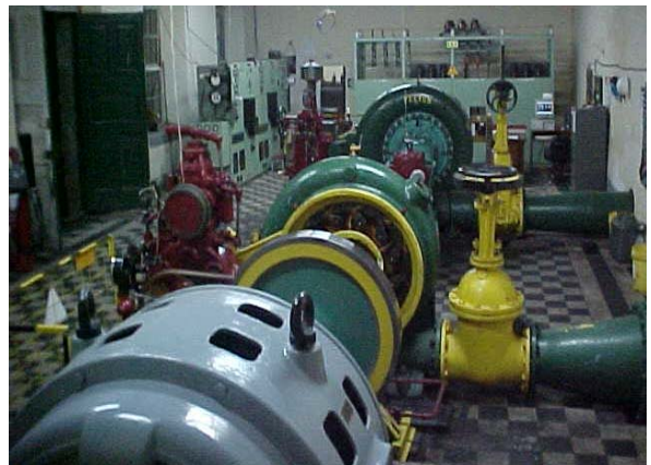
Sala de máquinas
