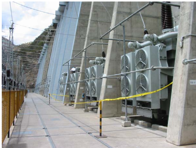
Transformadores de potencia
