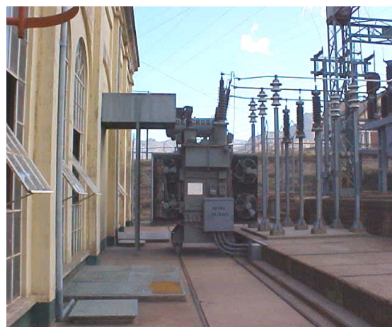
Transformador de potencia 15 MVA
