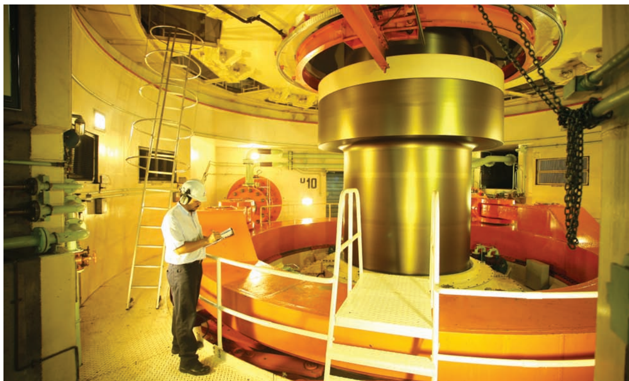
Unidad generadora. Fuente: Prensa Itaipu Binacional.
