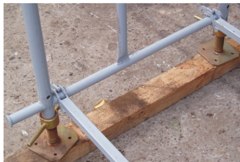
Рис. 2. Винтовые опоры в конструкции строительных лесов
