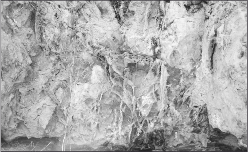
Foto 1 - Agrietamiento en el contacto entre las formaciones Jagua y Guasasa.
