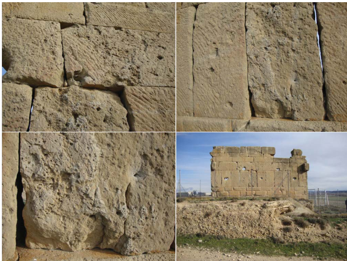
Fig.5.- Avanzado grado de erosión de los sillares de la cara sur y vista general de la misma cara.
