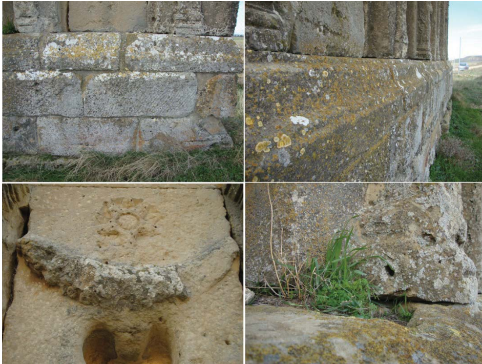
Fig. 7.- Diversos ejemplos del biodeterioro del edificio. Líquenes en diversas tonalidades y plantas de medio porte
