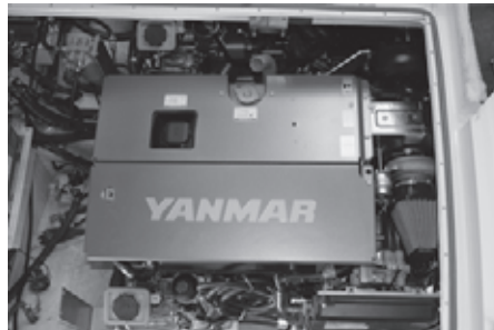
Blick in den Motorenraum des Kolin 10.
