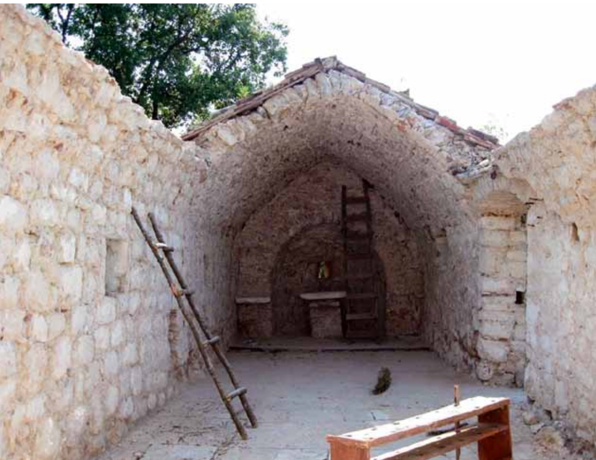
Унутрашњосћ цркве са срушеним сводом млађе фазе (након припремних радова)
