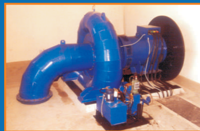
Turbina de 320 KW.
