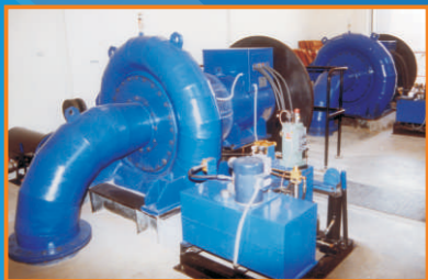
Turbinas Francis de 160 KW. c / u
