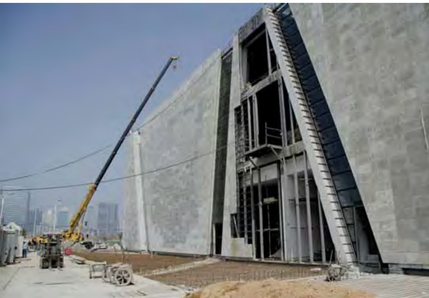
Fase costruttiva del montaggio dell'involucro esterno costituito da pannelli in cemento trasparente
