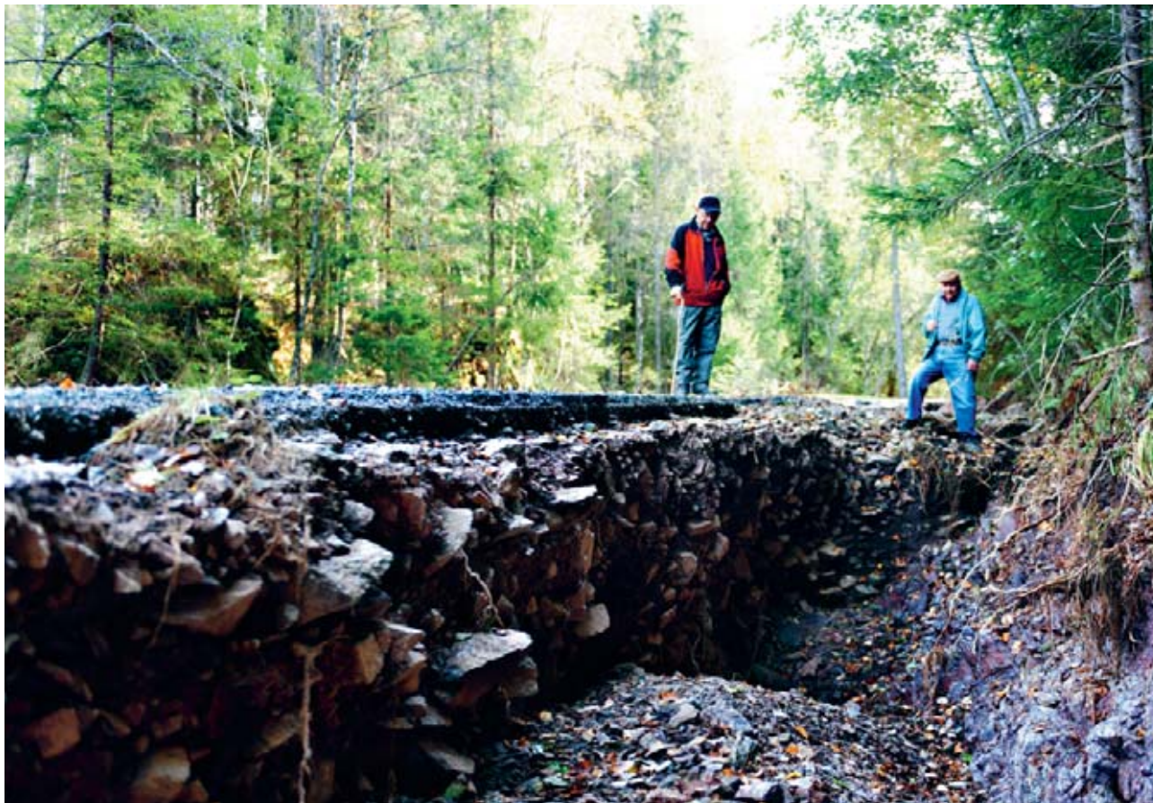
Brødrene Per Thoner og Ole Bjarne er ute på befaring. De ser resultatene av den våteste sommeren i manns minne – halve veien er skyllet vekk.
