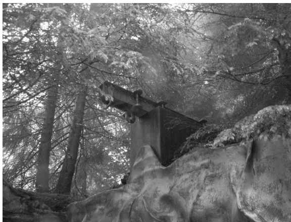
Abbildung 17: Kranschiene beim Eingang zur Anlage
