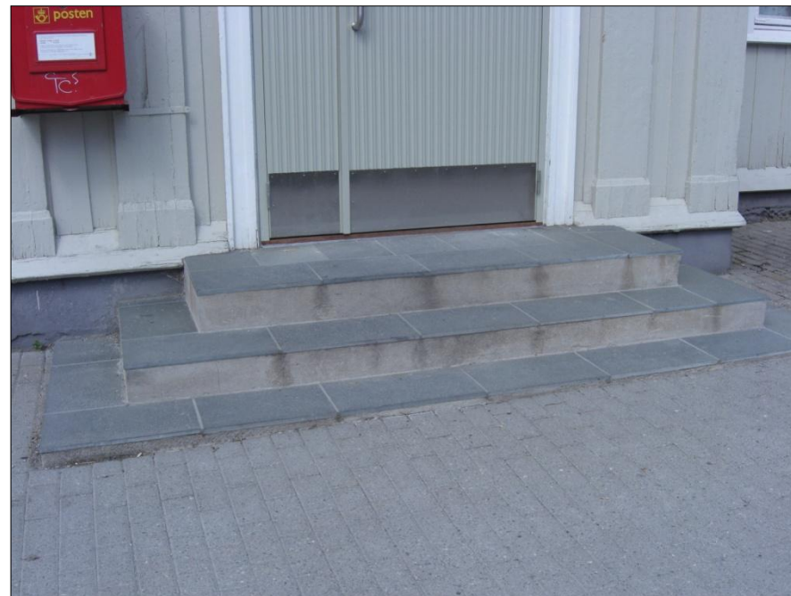
Foto 1: Inngangsparti til stasjonsbygg. Trapper foran sør som åpner automatisk. Trappene er ikke merket og har dårlig kontrast, både til omgivelsene og mellom trinnene. Trappene gjør atkomstene utilgjengelig for rullestolbrukere, og vanskelig tilgjengelig for temporært forflytningshemmede, barnevogner og syklistler.
