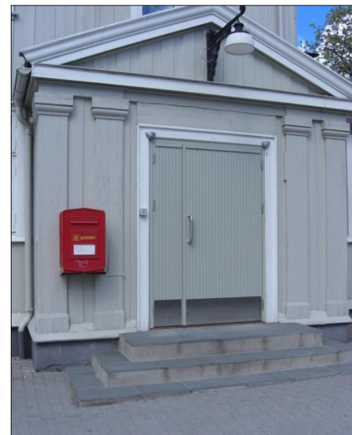
Foto 5: Trappene til hovedatkomsten gjennom stasjonsbygget er ikke tilrettelagt for synshemmede eller bevegelseshemmede.
