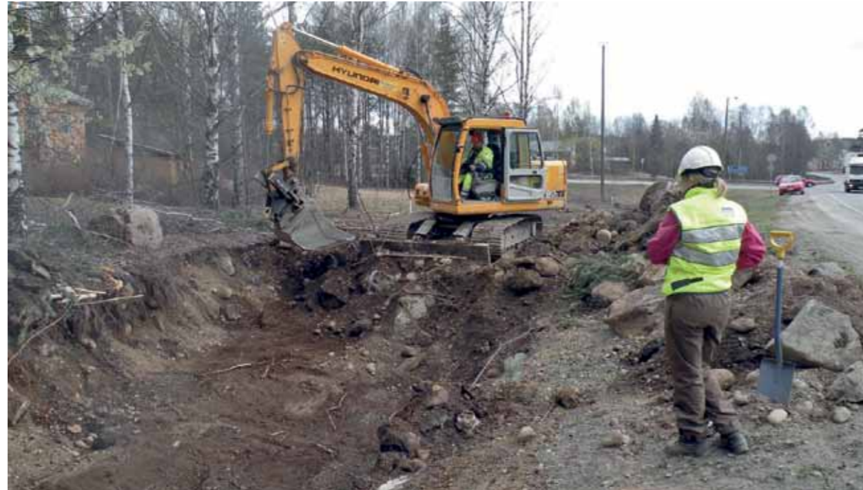
Kaivuutyö aloitettiin poistamalla kaivinkoneella sekoittunut, 1950-luvun tierakennuksen yhteydessä paikalle tuotu maakerros. Kuva PMM/ Mari Luukkonen
