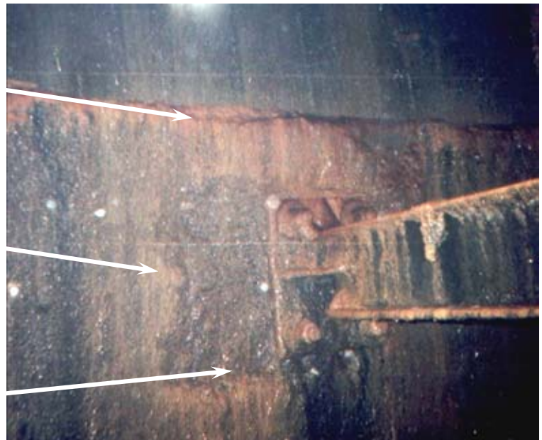
Рис. 1. Фрагмент монолитной бетонной крепи вентиляционного ствола №1 шахты им. Чиха в месте крепления расстрела
