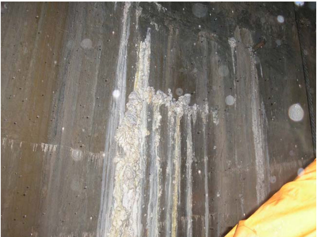
Рис. 6. Проявления реагирующего с водой Аквидура ЭС на бетонной крепи ствола.
