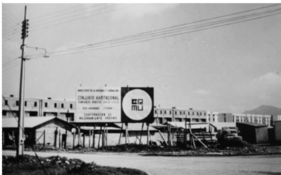
Imagen de las faenas de construcción de la Villa Ministro Carlos Cortés (Villa San Luis), (año 1971). Fuente: Archivo personal de Miguel Lawner.
