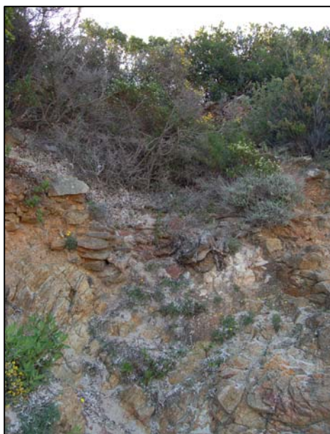
Four envahi par la végétation (avril 2007)
