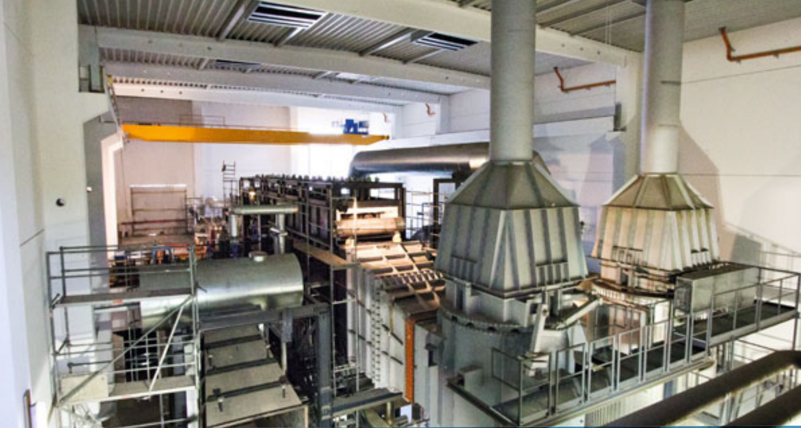
Das Biomasse-Heizkraftwerk am Hauptsitz in Sengenthal: Blick von oben auf die hochmoderne Anlagentechnik mit dem speziell entwickelten Luftherhitzer in Bildmitte
