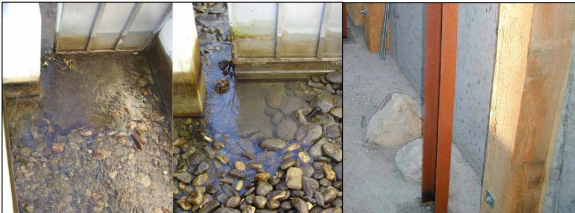
Abb. 21: Unerwünschte Geschiebebewegung im Schlitzbereich eines Schlitzpasses führt zu einer Beeinträchtigung der Funktionalität vor allem für bodenorientierte Arten und geänderten Fließgeschwindigkeitsbedingungen durch den Verlust von Rauigkeit (links) (Wiesner et al., 2007); Einbau fixer Strukturen, um diese Geschiebebewegungen zu vermeiden (rechts) (Gumpinger & Siligato, 2005).
