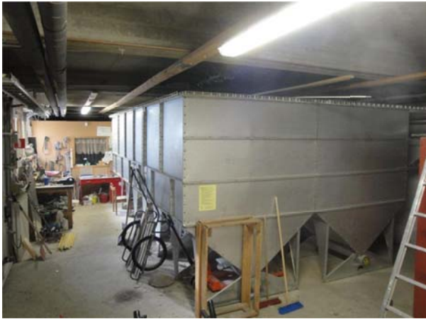
Bild 4 Pelletsförråd i källarutrymme i en skola. (Foto U. Svedberg).
