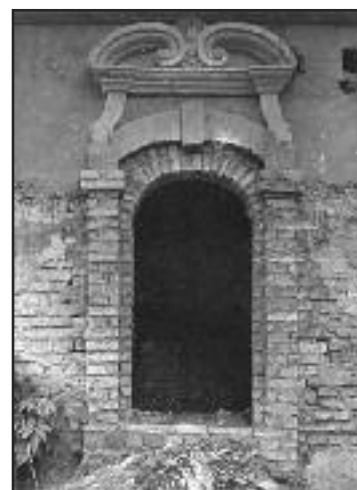
Будинок колишньої ключні (корпус № 1 – за сучасною нумерацією). Фрагмент. Вікно південного фасаду. В процесі реставрації. Фото 1958 р.
