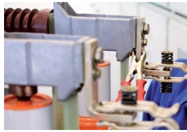
Betriebsführung und Instandhaltung elektrischer Anlagen
