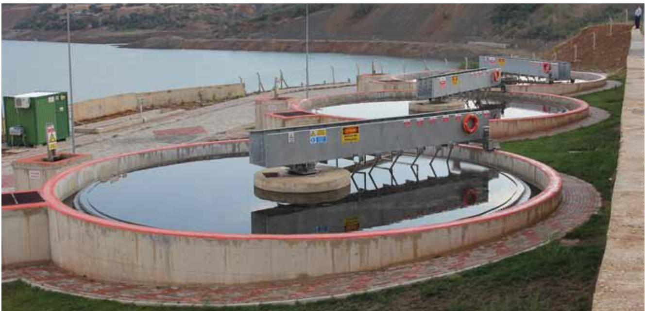
Tunceli Atıksu Arıtma Tesisi
