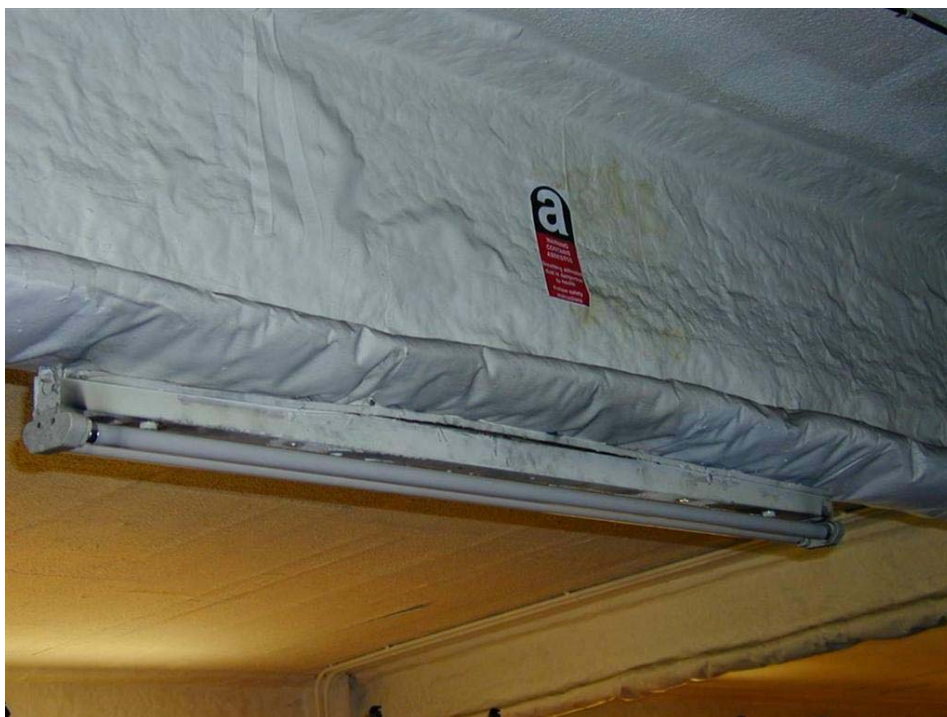
4.11. ábra Azbesztszigetelés acélszerkezeten
