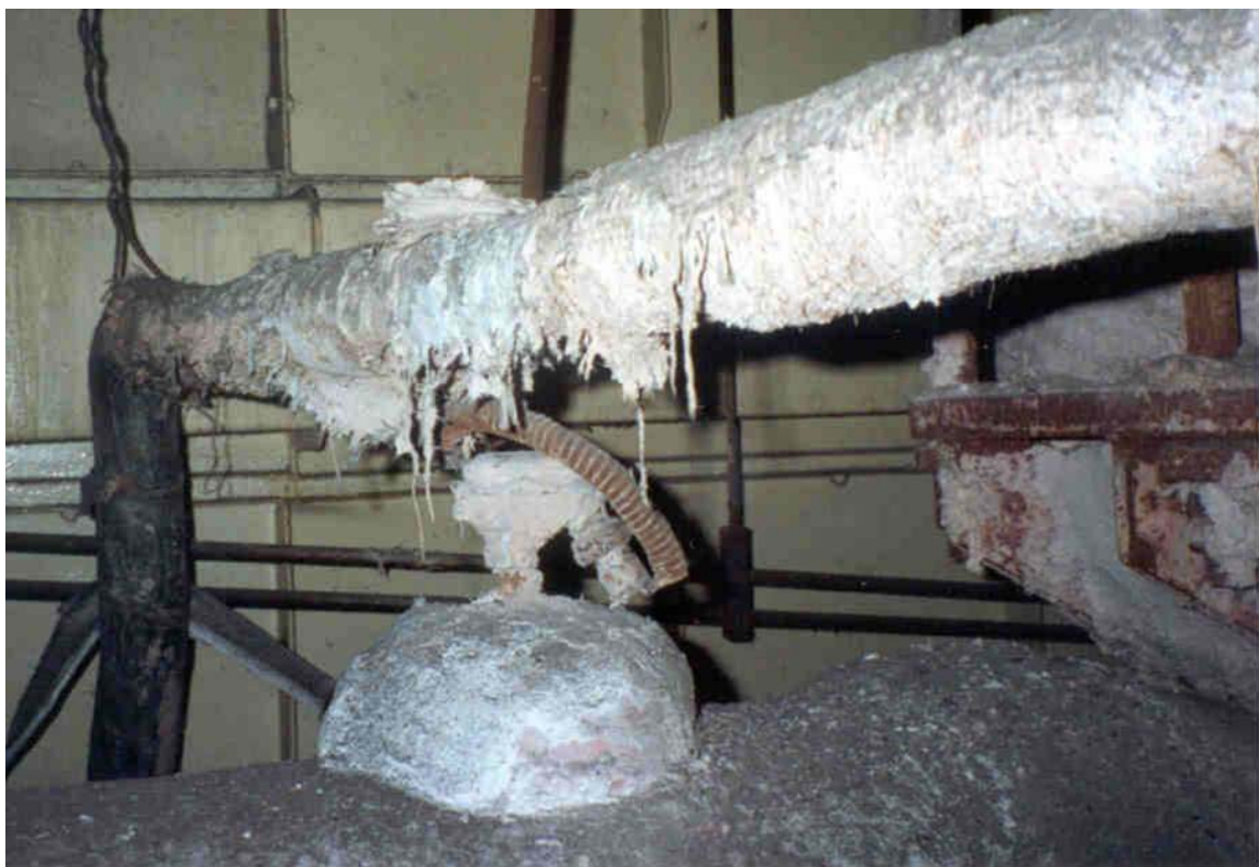
4.8. ábra Azbeszt szigetelés gőzvezetéken
