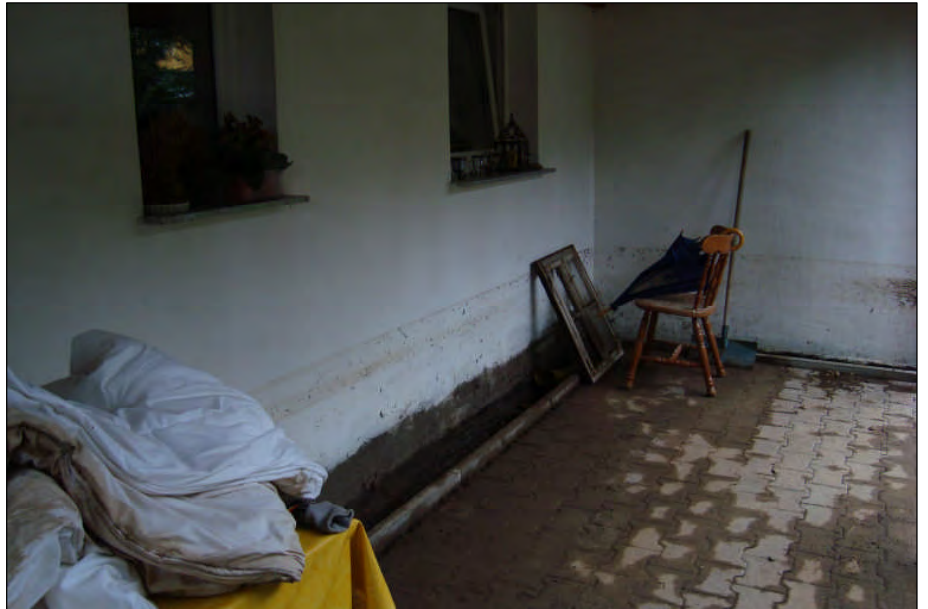
Abb. 38: Hochwassermarke am Bachweg, 16.08.2010
