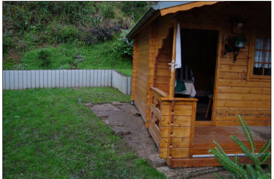
Abb. 37: Aus der Verankerung gerissenes Gartenhaus am Bachweg, 16.08.2010
