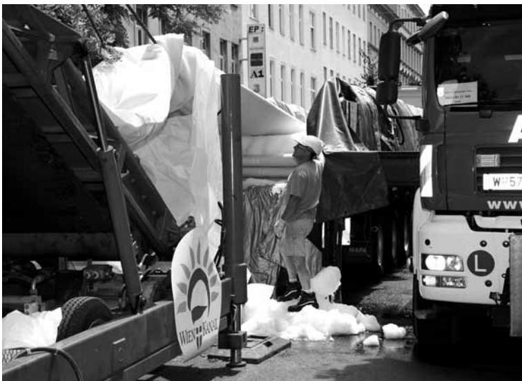
Mit Schnee und Eis wird der Kleber kühl gehalten und härtet während des Transportes nicht aus. © Wien Kanal
