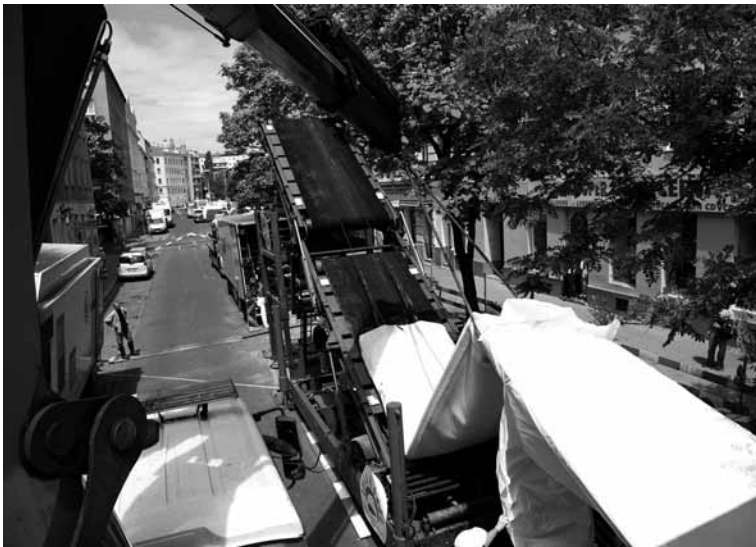
Vorrichtung zum Einfädeln des „Inliners“ auf der Kanalbaustelle Hannovergasse im 20. Bezirk. © Wien Kanal
