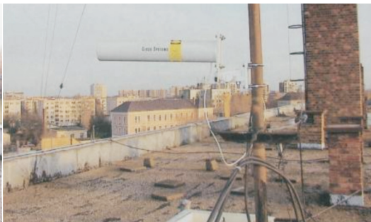
15. sz. kép Sóstói úti legmagasabb épület tetejére helyezett mikrohullámú adó-vevő
