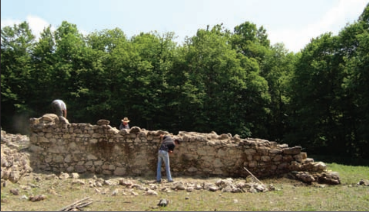
Pogled na sjeverni zid samostanske crkve sv. Petra tijekom pripremnih radova (foto: T. Pleše)
