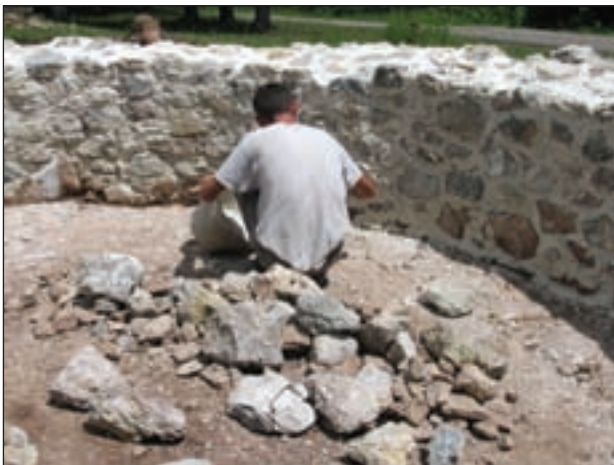
Budinjak – kapela svete Petke, završna obrada konsolidiranih temelja sa zaštitnim konzervatorskim slojem (foto: M. Želle)
