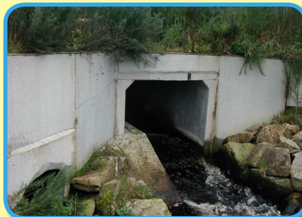
un loutroduct, passage sous la route qui permet à la loutre de traverser sans se faire heurter par des véhicules
