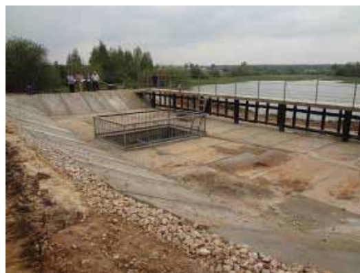
Фото 2. Капитальный ремонт ГТС на ручье б/н у д. Малый Шаплак №2 Медведевского района
