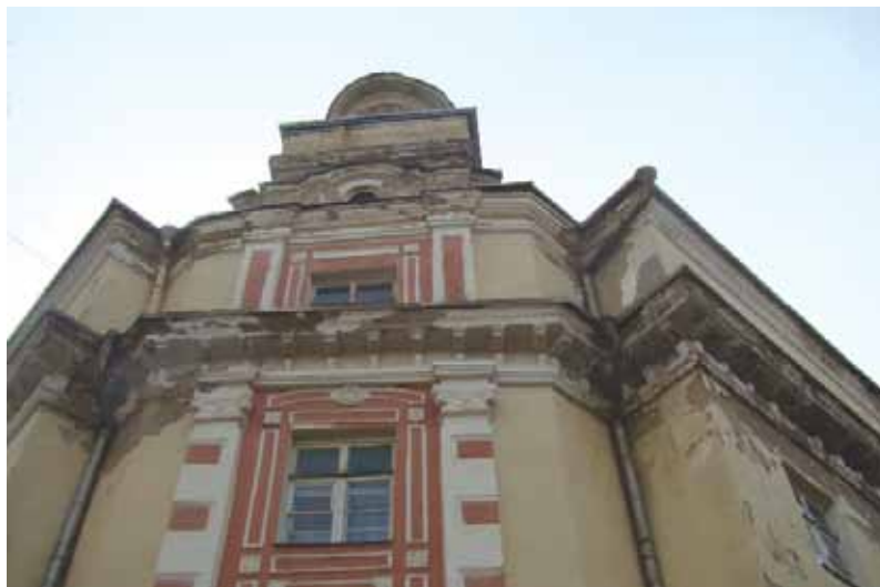
Фото 8. Фрагмент ОКН «Дом жилой, середина XX века» (ул. Волкова, д. 164). Разрушение карнизов и отделки фасадов. 23.05.2013 г.
