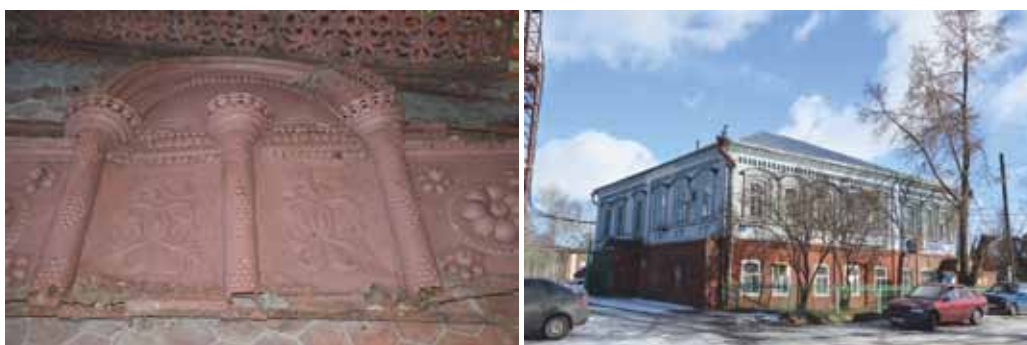
Фото 12. ОКН «Дом в кирпичном исполнении с ажурными металлическими карнизами» (пгт. Юрино, ул. Касаткина, д. 8): а – фрагмент аварийного состояния демонтированного карниза; б – общий вид здания. 13.03.2013 г.
