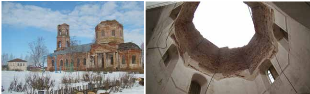
Фото 13. «Церковь святых Бессребреников Космы и Дамиана, 1887 г.» (с. Орша): обрушение аварийного кирпичного свода восьмерика. 19.04.2013 г.
