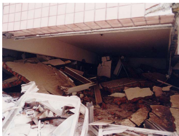
大樓往下陷落，造成一樓居民遭到活埋的慘劇。
