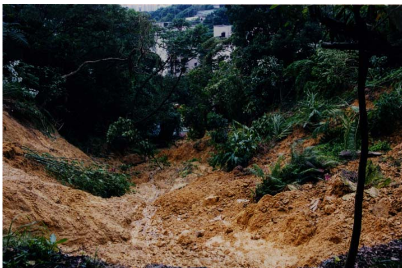
崩塌地上方至下邊坡之狀況，外貌呈上寬下窄。
