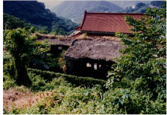
凌雲禪寺後殿為巨大石塊衝擊壓毀後殘留之情形。
