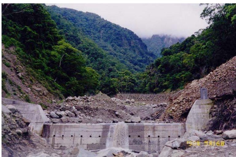
二號攔砂壩以上，土石堆置並未流失，壩體右側為土石流監測與發報儀器，於此次土石流發生時未適時發揮作用。
