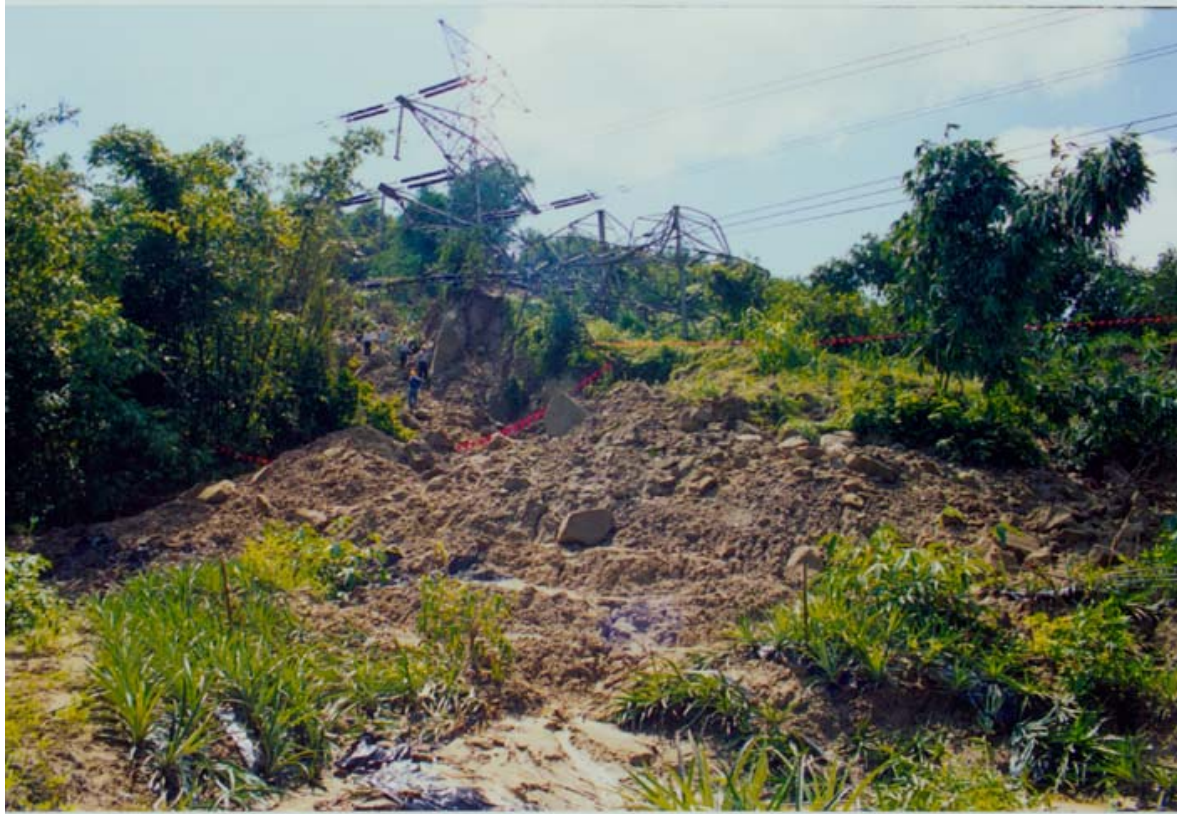
倒塌之326號電塔，塔頂為高壓線所牽住，塔基向西北西方向滑移約二十餘公尺。
