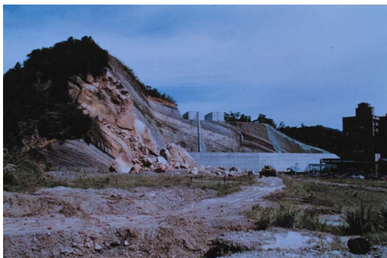
林肯大郡社區邊坡開挖不到數年後，在溫妮颱風期間造成落石崩塌，幸未釀成災害。
