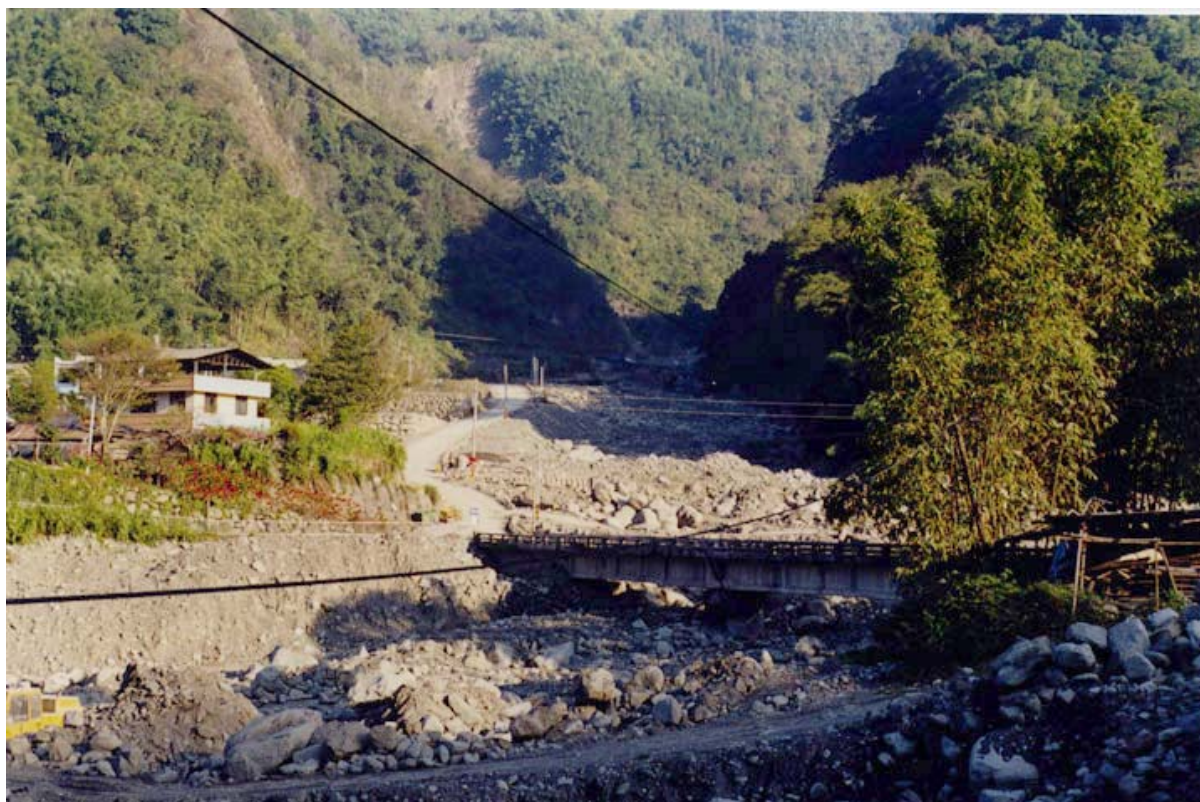
土石流發生前之霍薩溪橋，橋下空間尚約有1.7公尺。左側為神木國小，正前方野溪為出水坑溪，右側為郝馬嘎班溪，二者於橋右約五公尺處會合後往左流入和社溪。(86年12月14日拍攝)
