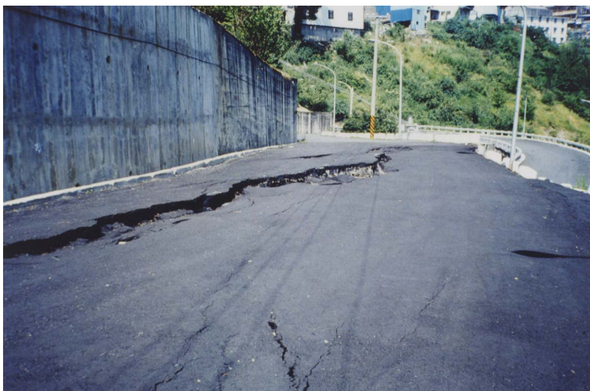
梨山地滑造成多處路面沈陷龜裂。（王文能 攝）
