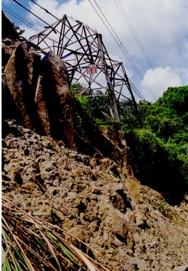
326電塔築於膠結疏鬆的厚砂岩上，基礎淺，隨著這次砂岩滑動而下移。
