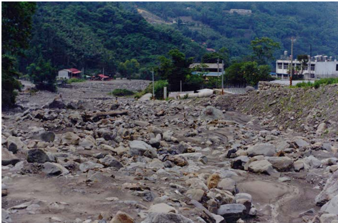
一號攔砂壩以下緊臨神木國小之出水坑溪河床表面，多堆積細顆粒砂土，具流動現象，河床上亦堆置為量不少之竹頭與木塊。
