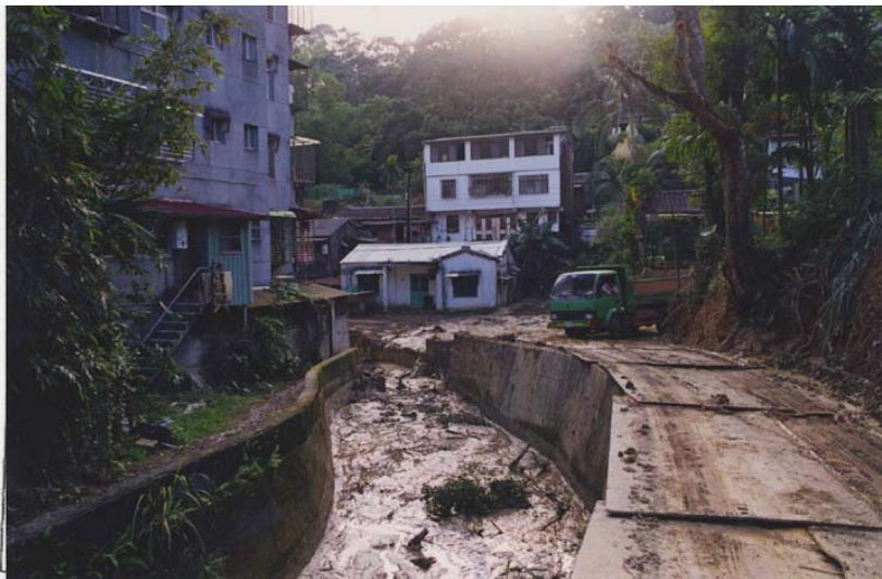
山坡上游二條溪溝流至山腳匯集，排水溝並未擴大，致排水量縮減（分佈圖 p-2）。
