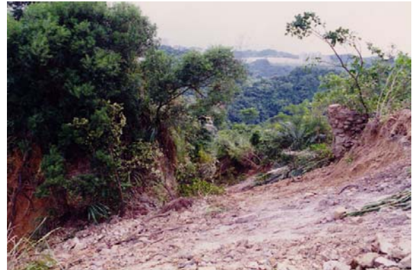
殘留之分離陡崖表層為厚約一公尺之高度土壤化砂、頁岩互層（照片右側），掩覆在其下者為中度風化的頁岩，緊接著為新鮮頁岩滑動面。
