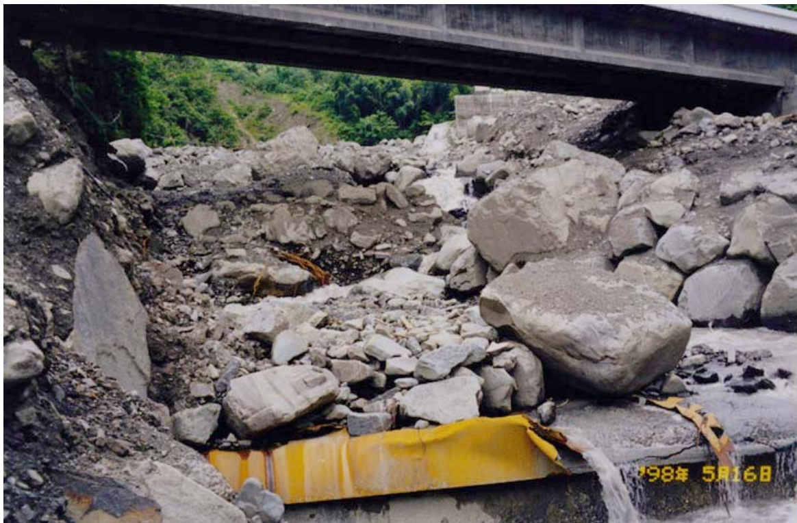
跨於出水坑溪之「郝馬嘎班溪橋」下巨石磊磊，表面上有砂土殘積，前側之結構體為一號攔砂壩。
