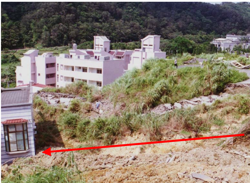
別墅房舍沿回填土之河道下滑，圖中後棟白色建築物部份亦有沉陷現象發生。
