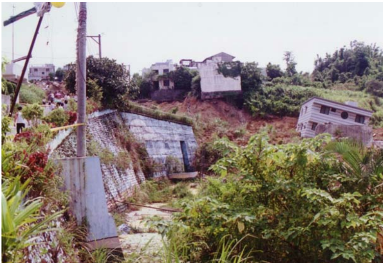
護坡雖已崩毀，但從遺留尚完整的護坡中明顯觀察到並未設置有任何地下排水管設施。
