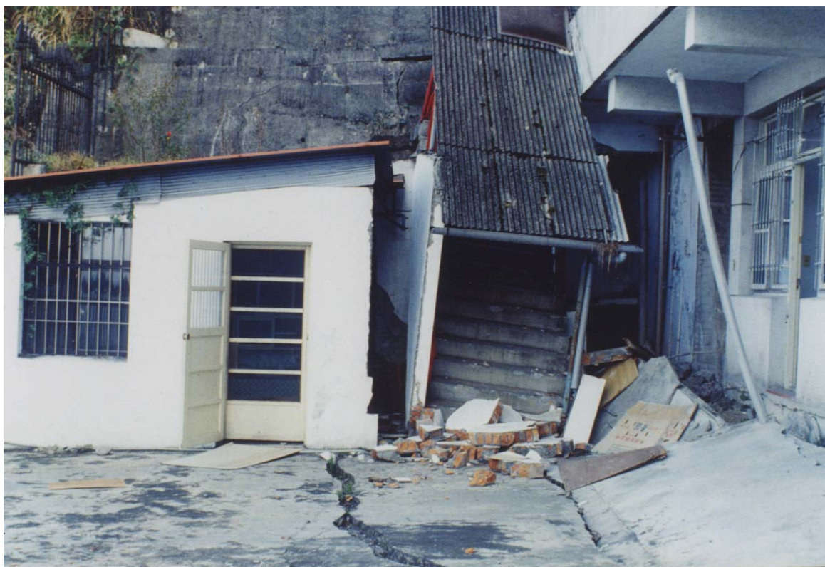
梨山管理所活動中心因地滑造成建築物損壞。（王文能 攝）
