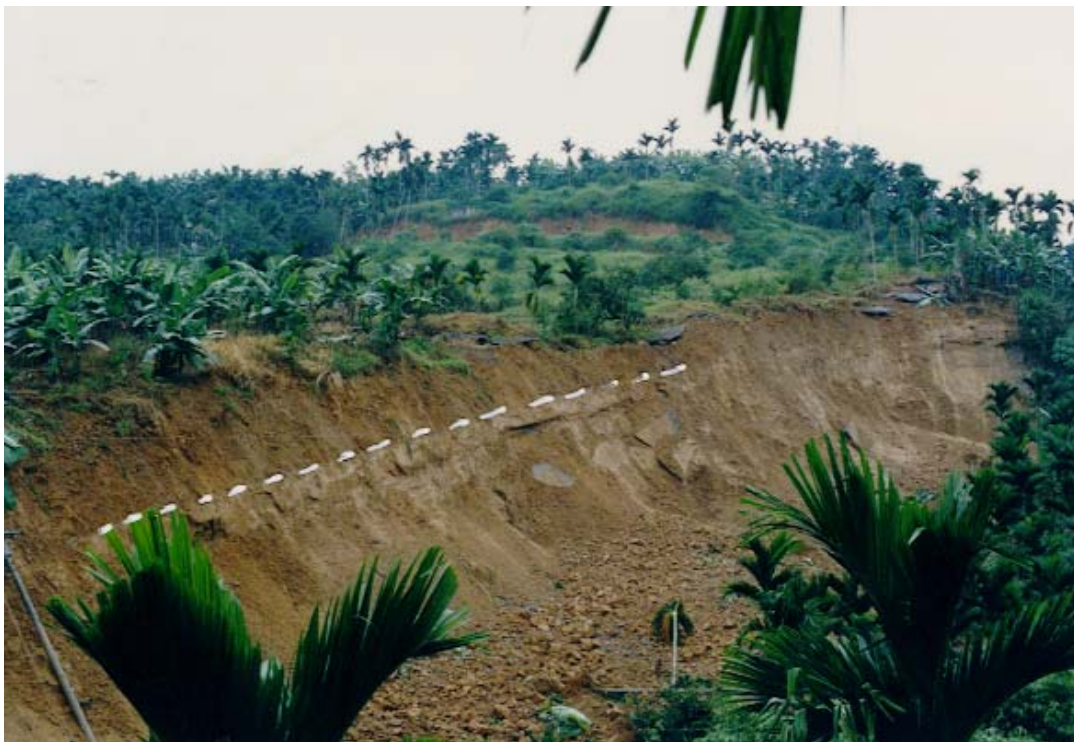
本山崩區內以平面型滑動為主，滑動方向與地層傾斜方向平行。白色虛線為滑動面，上層為鬆散的表土，部份崩落至崖面下方堆積，滑動面以下為岩盤。
