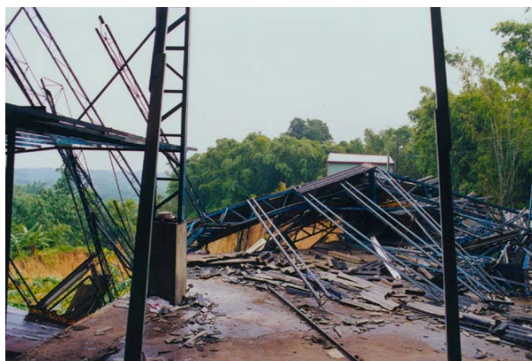
龍崎兵仔舍地層滑動引發房舍倒塌跌落谷中。
