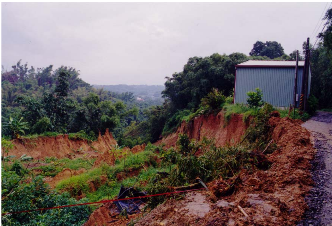
八月八日龍崎兵仔舍發生山崩的現場，路旁農舍岌岌可危。
