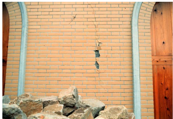
凌雲禪寺後殿外牆因受石塊撞擊，造成龜裂情形，照片前方石塊為衝入殿內的岩塊。
