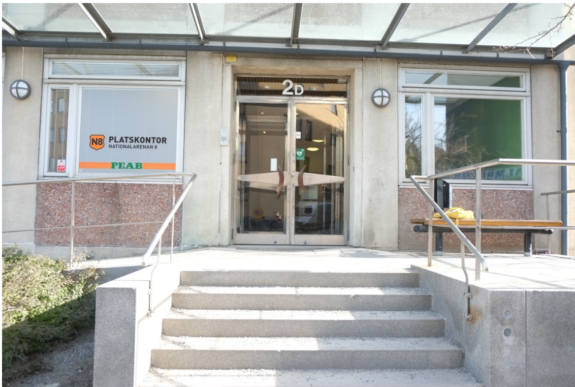
Byggnadens huvudentré med ursprungliga dubbelkopplade fönster med ytterbågar i aluminium och innerbågar i trä samt dörrpartier i rostfritt stål.
