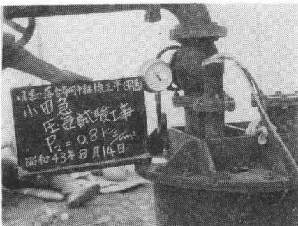
写真-2 ケーシング上端の状態
