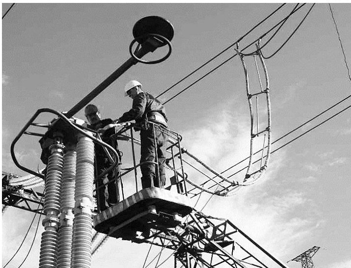
Рис. 4. Монтаж устройства активно-индуктивной защиты от внутренних перенапряжений на подстанции 330 кВ вблизи г. Апатиты
