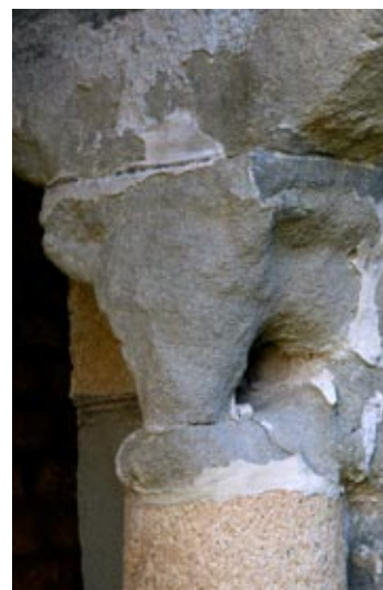
Estat de degradació de la pedra abans de la restauració
