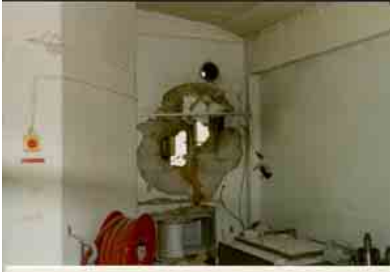
Yläkuva: Puristinhuoneen turvaseinän vauriot Keskikuva: Sama seinä kuvattu alakerran konehuoneesta Alakuva: Sama seinä kuvattu suojahuoneesta
