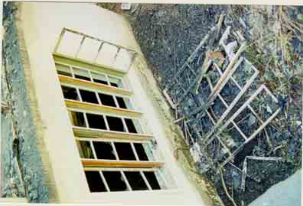
Yläkuva: Puristihuoneen alapuolella oleva huone, ruutikouru Alakuva: Saman huoneen ikkunavauriot
