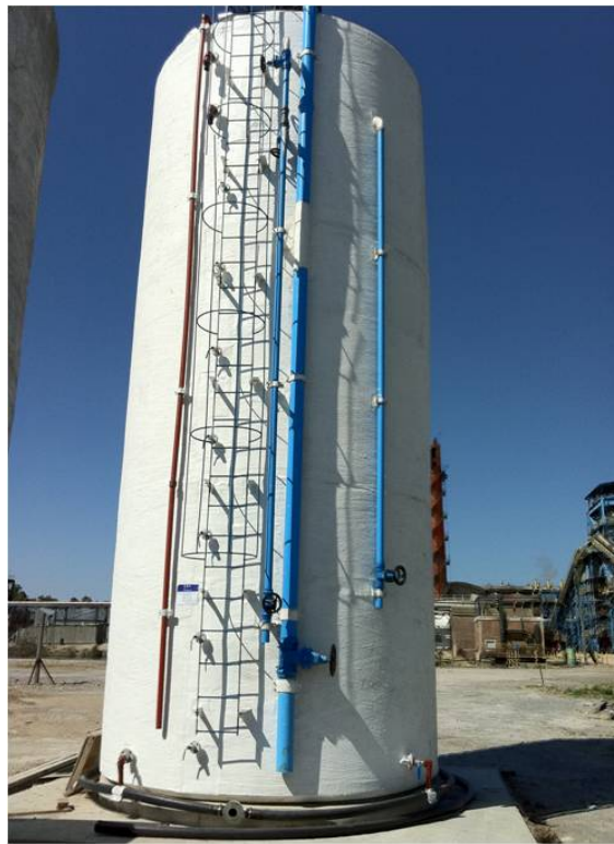
Figura 1 Reactor UASB de 100 m 3 para el tratamiento de la vinaza, instalado en la planta de ALUR, Bella Unión.
