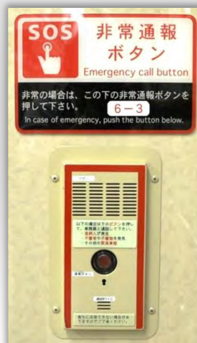
非常通報ボタン (南北線・東西線車両)
