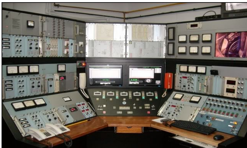
Imagen de la Sala de Control del reactor nuclear RA-1.
